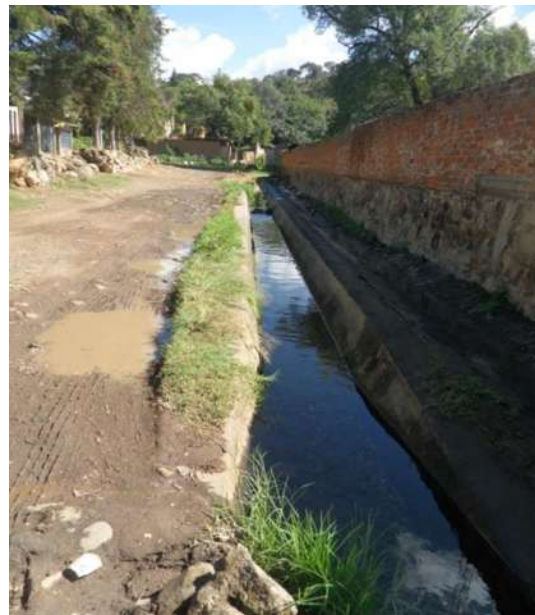
Imagen 2. Daños causados en el canal de agua
