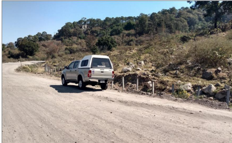
Figura 5.2. Sección de carretera afectada.
