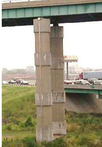
Figura 5.6. Esquema de la rehabilitación de encamisado de concreto reforzado de secciones circulares y rectangulares (Reginald DesRoches, 2008).
