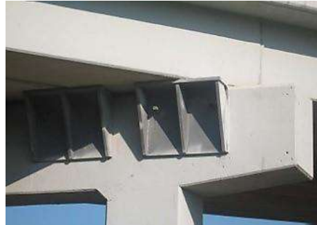
Figura 5.21 En puentes con esviaje se colocan dispositivos para aumentar el asiento de apoyo (Reginald DesRoches, 2008).
