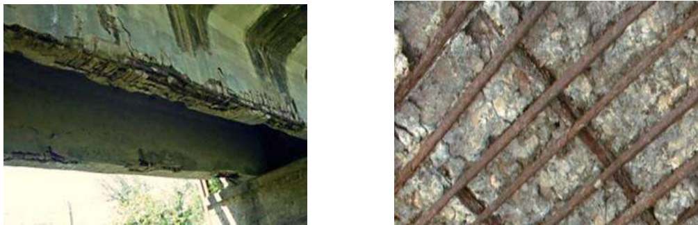
Figura 3.14. Acero de refuerzo expuesto a la intemperie por el desconchamiento del recubrimiento. (Composan, 2010).
