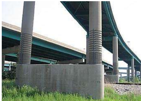
Figura 5.7. La rehabilitación de las columnas mediante la utilización de la técnica de pretensado externo concéntrico (Reginald DesRoches, 2008).
