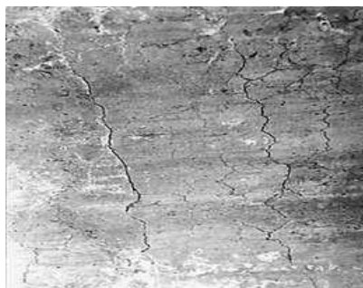
Figura 3.16. El daño generado por la presencia de contracción (M. J. Ryall, 2010).
