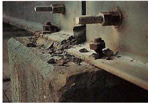
Figura 3.17. Presencia de corrosión en conexiones como remaches y tornillos corroídos (Masaki Tatsumi, 2007).
