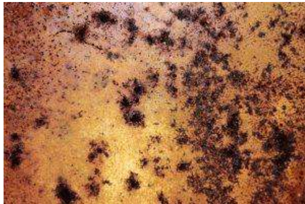
Figura 3.3. Corrosión por picadura. Fuente: https://www.bricolemar.com/blog/como-evitar-corrosion .
