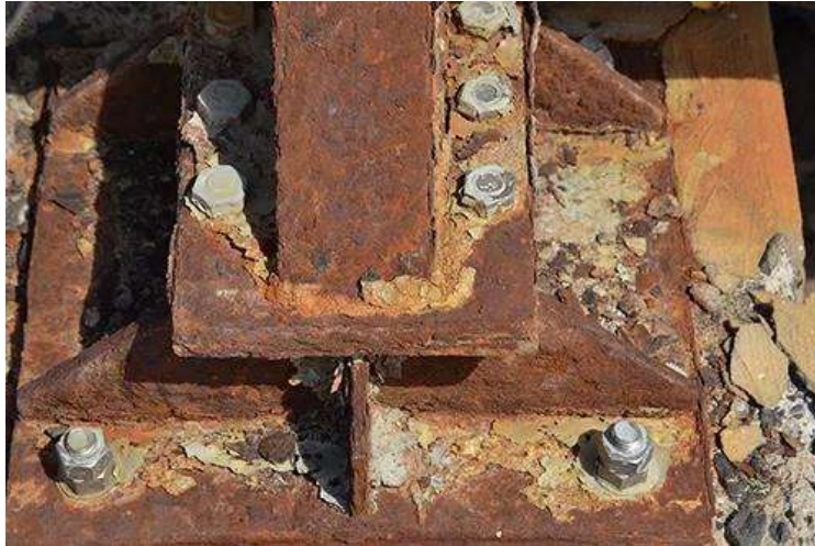
Figura 3.2. Corrosión generalizada. Fuente: https://www.nervion.com.mx/conocimientos/corrosion-tipos
