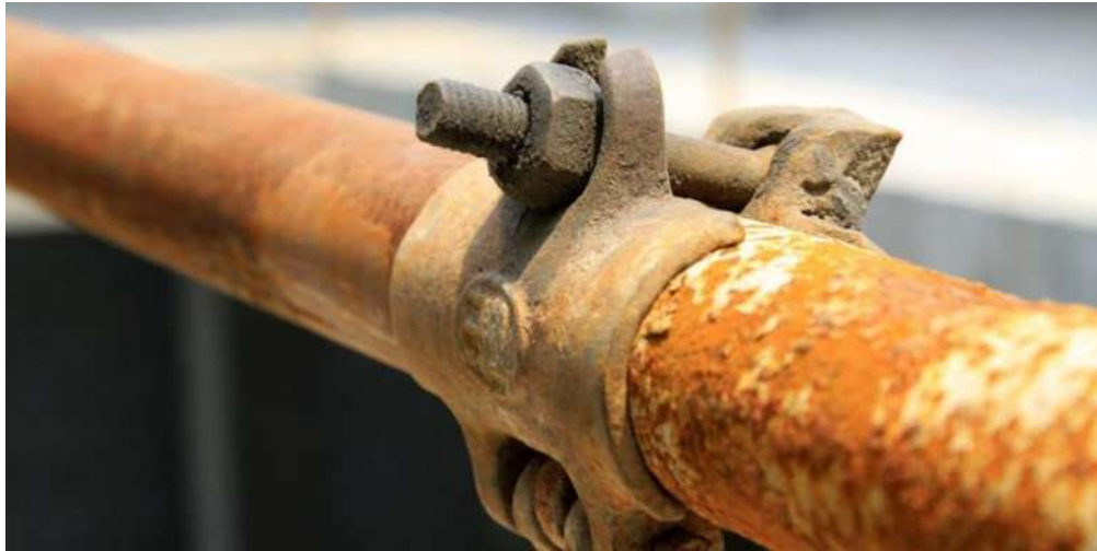
Figura 3.8. Corrosión Marina. Fuente: https://www.quimsaitw.com/como-evitar-la-corrosion-en-metales/ .
