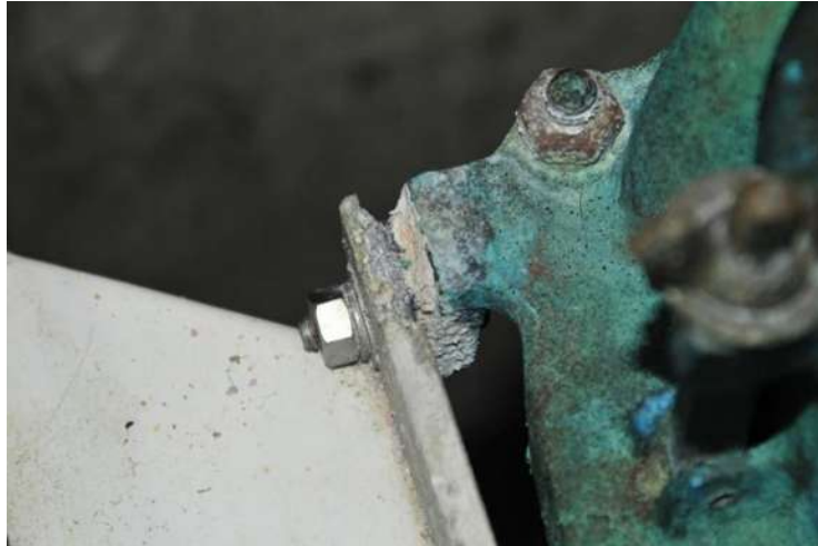
Figura 3.4. Corrosión Galvánica. Fuente: https://stevedmarineconsulting.com/understanding-and-preventing-aluminum-corrosion/ .
