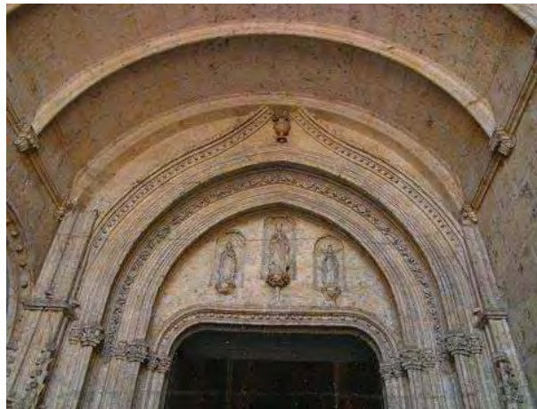
Foto 80. Puerta Norte de la Catedral. Se puede observar la mutilación de la puerta. Fuente: VFS, 2005
