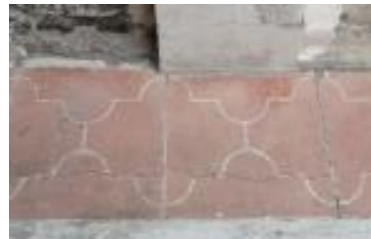
Grietas en pisos en pasillo
