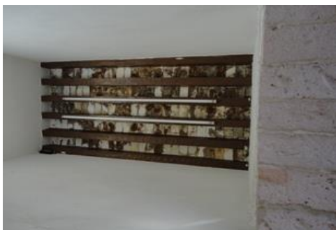
Humedad presencia de algas
