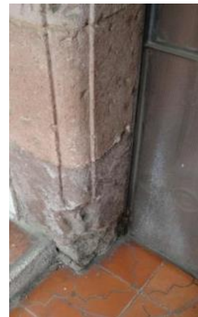
Desprendimiento de piedra en jambas
