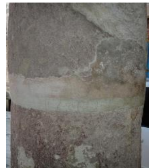
Exfoliación en fuste
