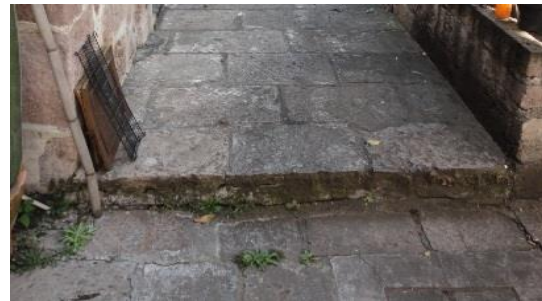
Presencia de vegetal y hongos. Disgración de juntas en piso del segundo patio.
