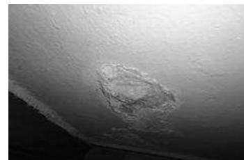
Desprendimiento de aplanados
