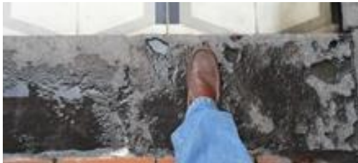
Desgaste de piso en encintado de cantera en el patio central
