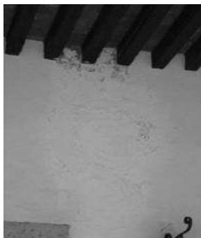
Húmedad por filtración
