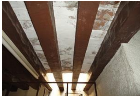
Desprendimiento de Pintura
