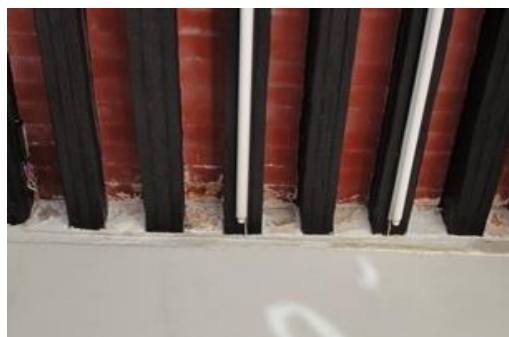
Presencia de eflorescencias
