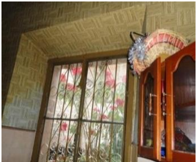
Imagen 15 Detalle de derrames en muros y capialzados en cerramientos.
