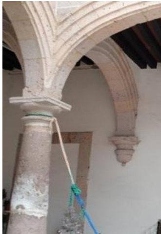
Presencia de Eflorescencias
