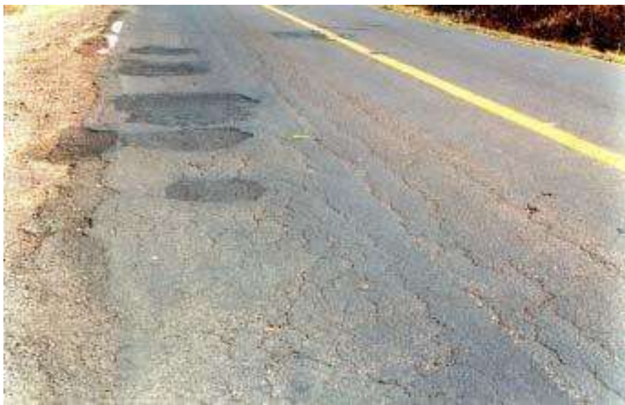
Ilustración 40.- Agrietamiento longitudinal (CONSEJO DE DIRECTORES DE CARRETERAS, 2002)
