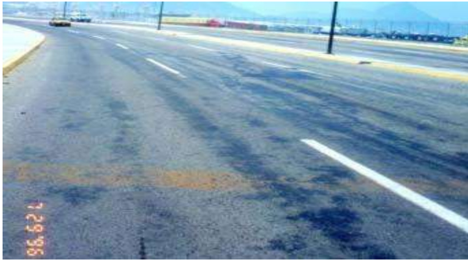
Ilustración 33.- Exudación de asfalto (llorado) (CONSEJO DE DIRECTORES DE CARRETERAS, 2002)
