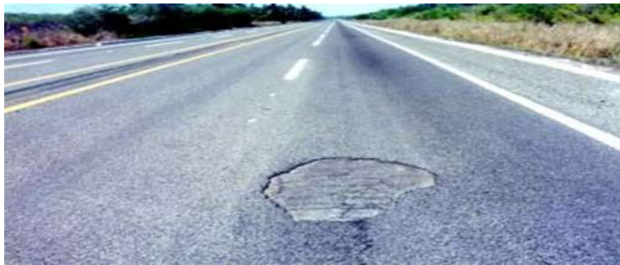
Ilustración 31.- Pérdida de capa de rodadura (CONSEJO DE DIRECTORES DE CARRETERAS, 2002)
