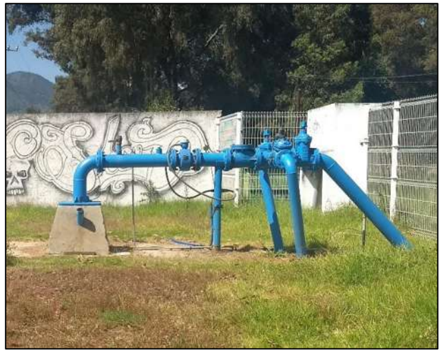
Figura 16. Pozo de extracción de agua subterránea (P4-A), que abastece a las colonias 2 de Octubre, Barrio del prendimiento, San Francisco y Guadalupe.
