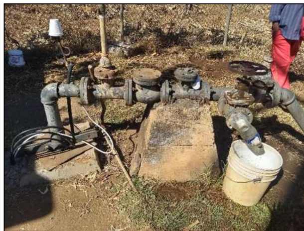
Figura 14. Pozo de extracción de agua subterránea (P2-A), que abastece a las comunidades de Joyitas y San Bernabé.
