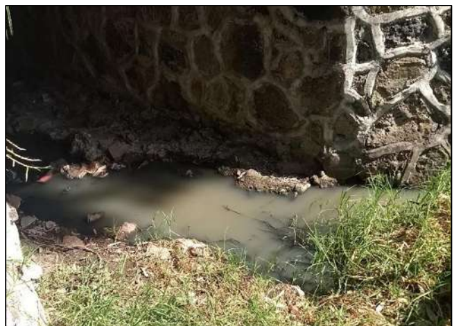
Figura 20. Descarga de aguas residuales de la colonia 2 de Octubre (AR-2).
