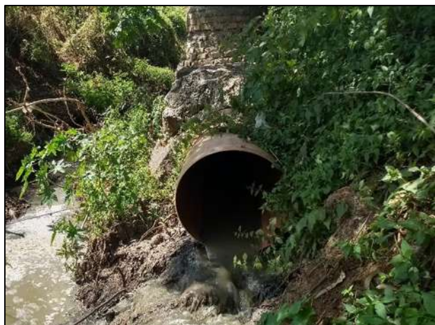
Figura 19. Descarga principal de aguas residuales de la comunidad de Capula (AR-1).
