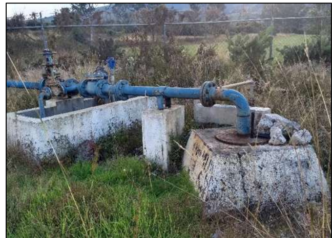
Figura 18. Pozo de extracción de agua subterránea (P6-A), que abastece a la comunidad de Iratzio.
