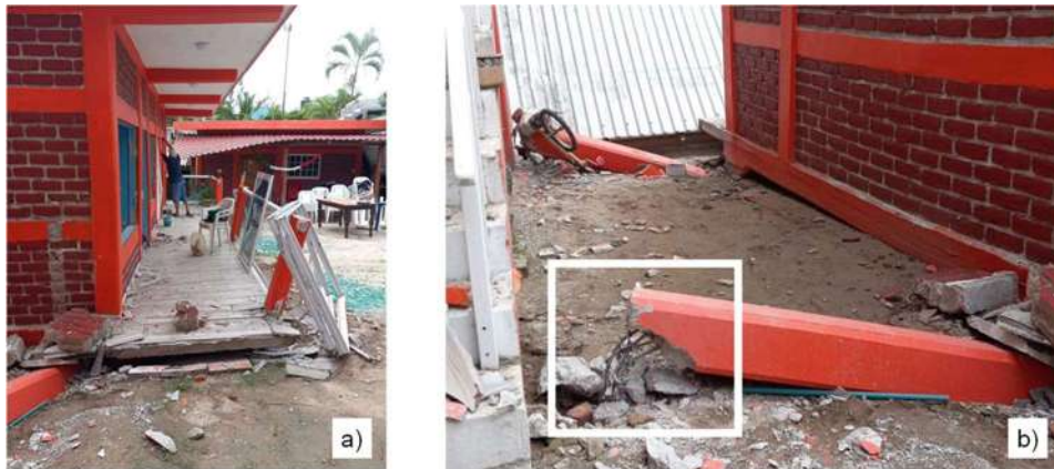
Figura 1.4. Colapso debido a la formación de un mecanismo de planta baja débil en uno de los cuerpos del Hotel Kalaki, ubicado en playa El Faro, Michoacán (facebook.com/kalaki, 2022).
