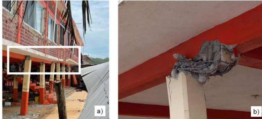
Figura 1.3. Colapso parcial en uno de los cuerpos del Hotel Kalaki, ubicado en playa el Faro, Michoacán: a) formación de articulaciones plásticas en columnas, y b) ausencia de refuerzo transversal de la columna (facebook.com/kalaki, 2022).
