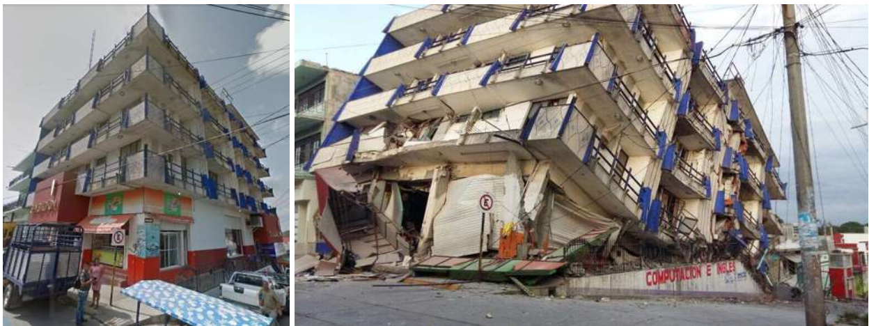
Figura 1.2. Colapso de un edificio (Hotel Anhe) con planta baja débil a consecuencia del temblor del 7 de septiembre de 2017 (en: @fflores): a) antes del sismo, b) después del sismo.
