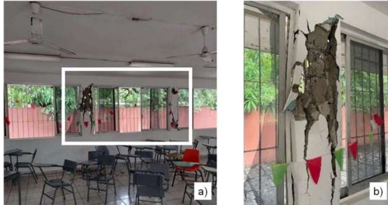
Figura 1.5. Daño en aula de la escuela secundaria “Gregorio Torres Quintero”, ubicada en Tecomán, Colima, a consecuencia del sismo del 19 de septiembre de 2022 (Mw7.6): a) daño estructural por “columna corta” en las columnas de planta baja, y b) ausencia y espaciamiento insuficiente del acero de refuerzo transversal en “columnas cortas” (Pablo Ávila Martínez, 2022).
