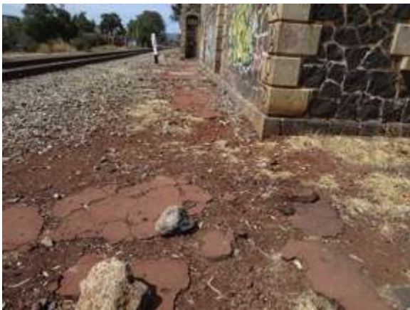
Figura 77: Área perimetral, firme destruido, realizar actividades de limpieza Fotografía: David García Villegas Marzo 2018
