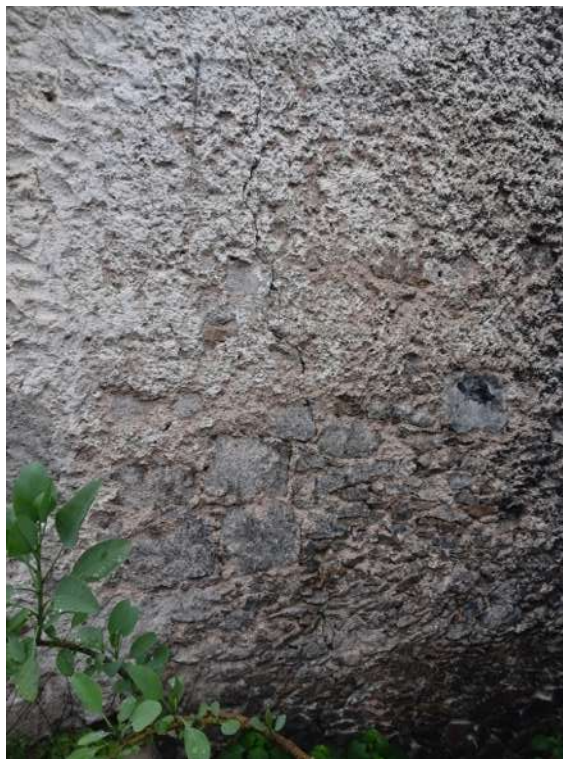
Figura 63: Bodega principal, deterioro en muros, pérdida de aplanado, Fotografía: David García Villegas Noviembre 2018
