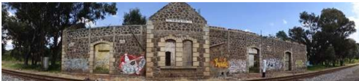
Figura 76: Fachada Sur, daños evidentes. - Fotografía: David García, Noviembre 2017
