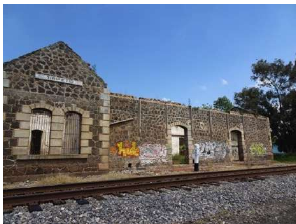
Figura 72: Fachada Sur, Falta de ventanas, portones y vandalización (grafiti). Fotografía: David García Villegas, Noviembre 2017
