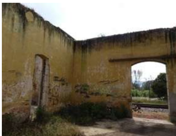
Figura 61: Bodega exprés, deterioros en muros, sin cubierta, basura y flora, Fotografía David G.V. 2018
