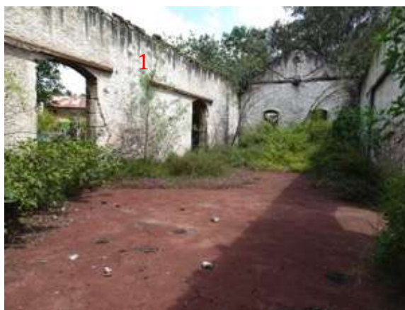
Figura 73: Interior de la estación de ferrocarril, bodega, falta de cubierta, flora, manchas. Fotografía: David García, Noviembre 2017
