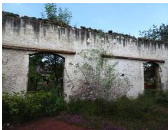
Figura 62: Bodega principal, deterioro en muros, sin cubierta, sin puertas, flora, Fotografía: David García Villegas febrero 2018
