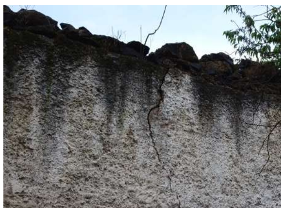
Figura 64: Bodega principal, deterioro en muro, grieta provocada por cambio de peso en la puerta norte oriente, -Fotografía: David García Villegas Noviembre 2018
