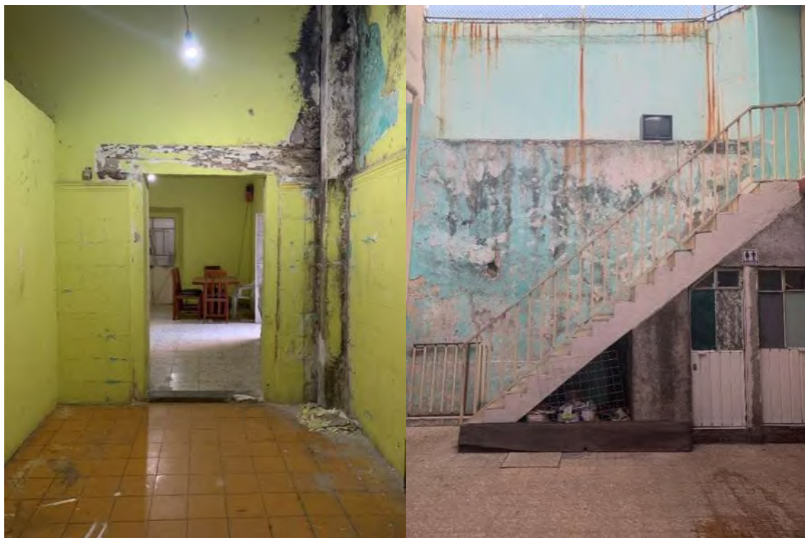
Ilustración 53 Deterioros por microflora en espacios de Caso de Estudio. Fotografías tomadas por autores.
