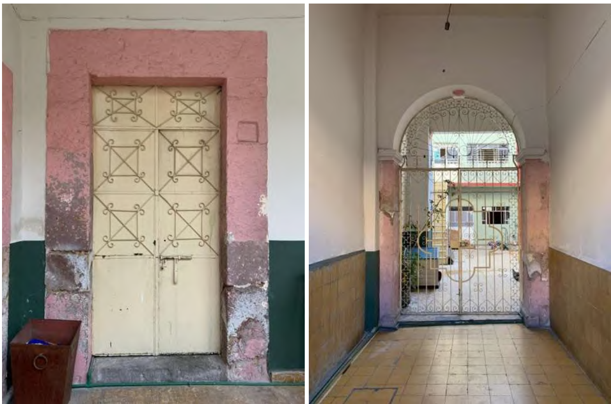
Ilustración 54 Presencia de eflorescencia en marcos de cantería. Fotografías tomadas por autores.
