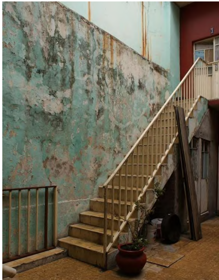
Ilustración 35 Humedad en Muro Medianero. Fotografía tomada por autores.
