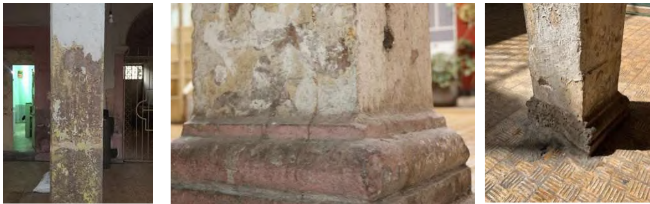
Ilustración 55 Pérdida de elementos y deterioros en apoyo aislado. Fotografías tomadas por autores.
