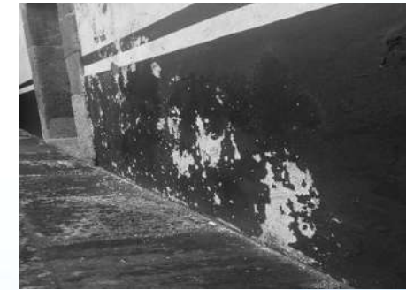
Figura 30. Humedad en patios
