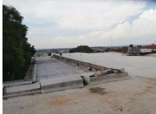
Figura 23. Humedad en azotea
