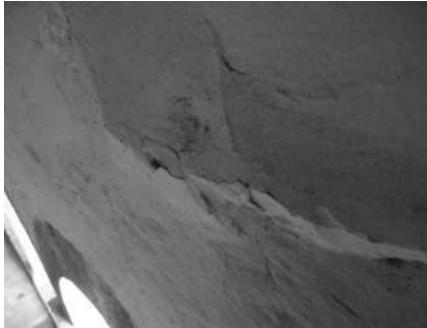
Figura 28. Humedad en interior
