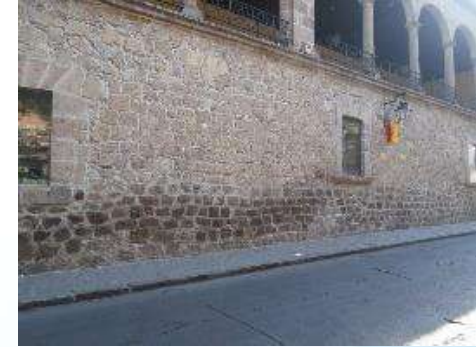
Figura 33. Humedad por capilaridad
