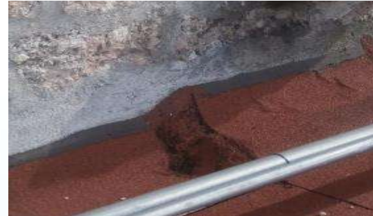
Figura 21. Impermeabilizante mal colocado
