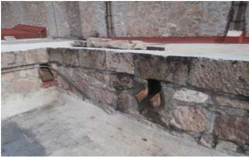
Figura 16. Bajadas de agua sin salida
