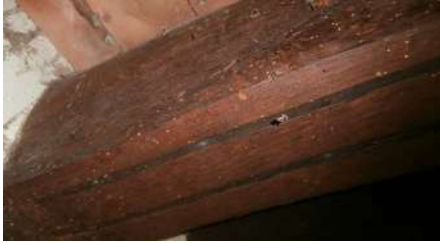
Figura 69. Estado mínimo de afectación
