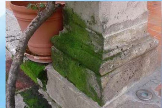
Figura 27. Humedad en columnas
