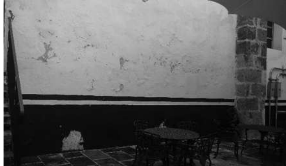
Figura 29. Humedad en muro exterior
