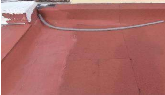
Figura 20. Fisuras en impermeabilizante
