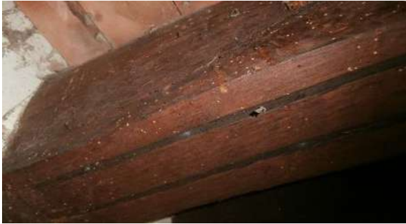
Figura 9. Estado mínimo de afectación
