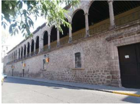
Figura 31. Humedad en fachada
