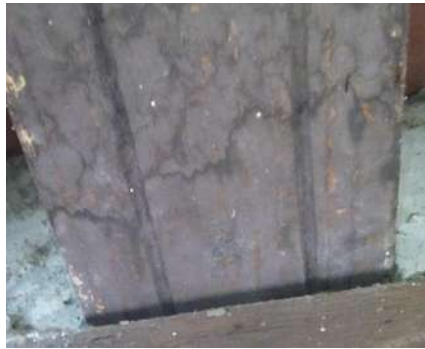
Figura 7. Estado medio de afectación
