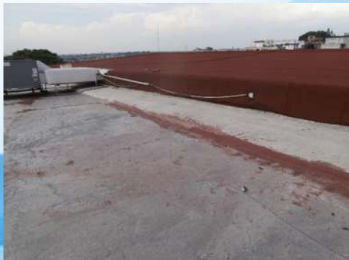
Figura 24. Desgaste de Impermeabilizante
