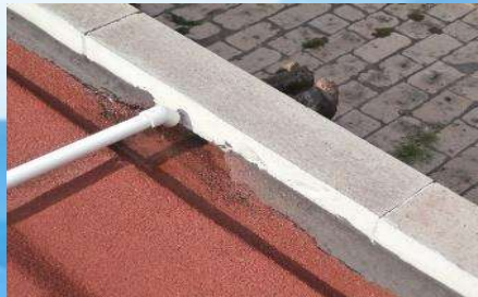
Figura 19. Gárgolas obstruidas por impermeabilizante
