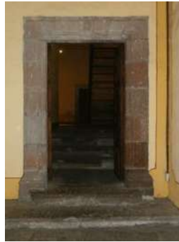
Figura 32. Humedad en interior
