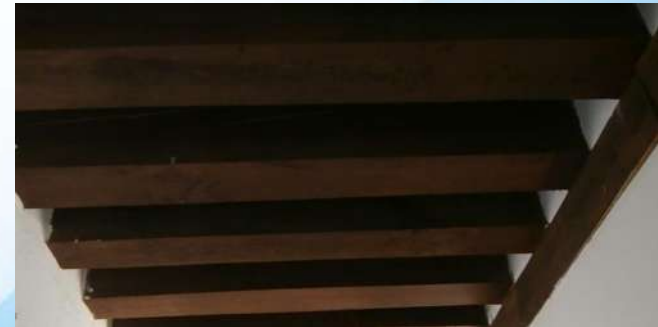
Figura 6. Estado mínimo de afectación
