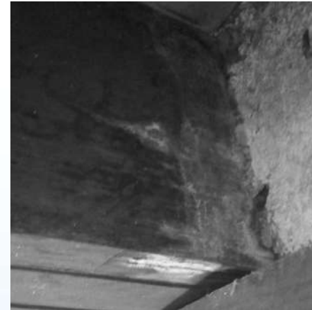
Figura 8. Estado crítico de afectación
