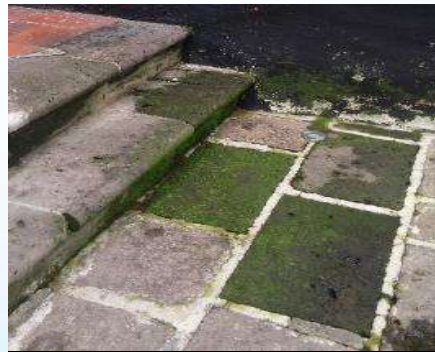
Figura 26. Humedad en pisos
