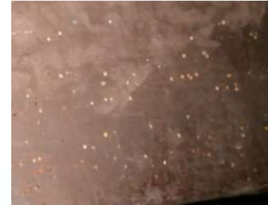
Figura 10. Estado medio de afectación
