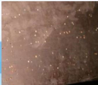
Figura 70. Estado medio de afectación
