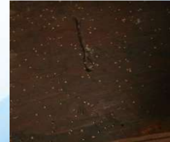
Figura 71. Estado crítico de afectación
