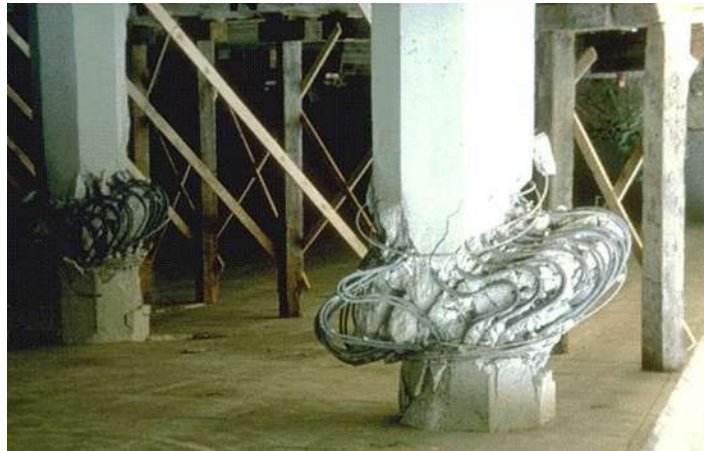
Figura 1.6. Falla de las columnas de un puente en una autopista interestatal (sismo de Northridge, 1994) [1.6].
