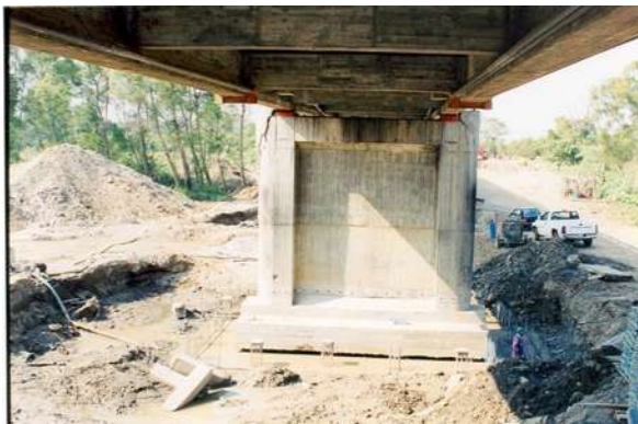
Figura 2.18. Se observa la pila no. 12 con la fractura de sus topes antisísmicos y los trabajos de recimentación a elaborarse.
