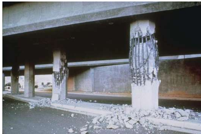
Figura 1.10. Falla de la pila central de un paso superior vehicular bajo el sismo de San Fernando en 1971 [1.10].
