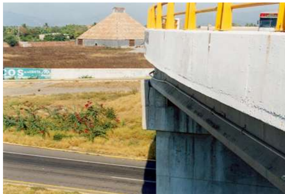
Figura 2.41. Fractura del tope sísmico en una de las pilas centrales.
