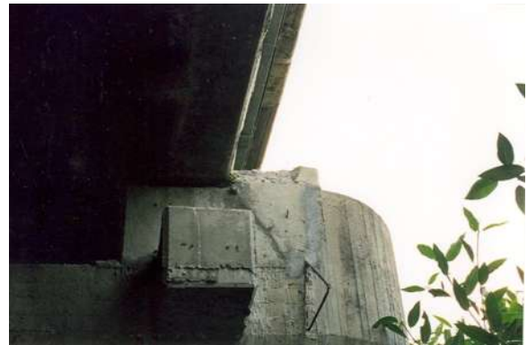
Figura 2.37. Fractura y desprendimiento del concreto en un tope sísmico.
