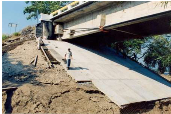
Figura 2.17. Reparación de uno de los estribos como consecuencia del asentamiento.
