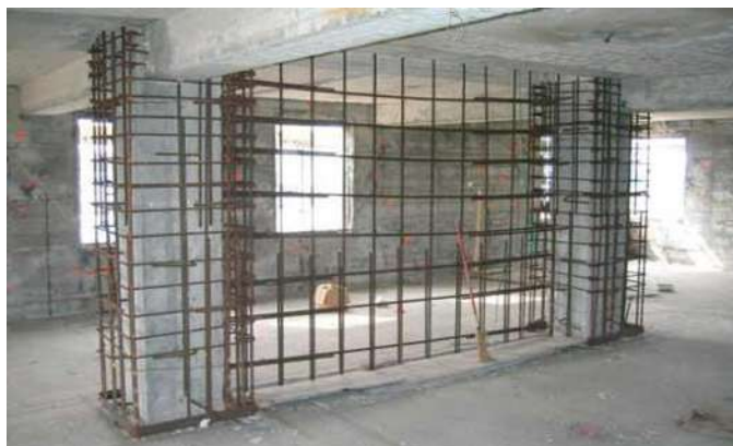
Figura 6.1. Elementos estructurales adicionales y la ampliación de las columnas. El FRP como alternativa de refuerzo minimizó los problemas de costo-tiempo y masas adicionales [28].
