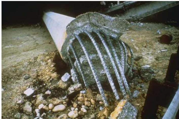
Figura 1.11. Colapso total de un puente interestatal bajo el sismo de 1971 [1.11].
