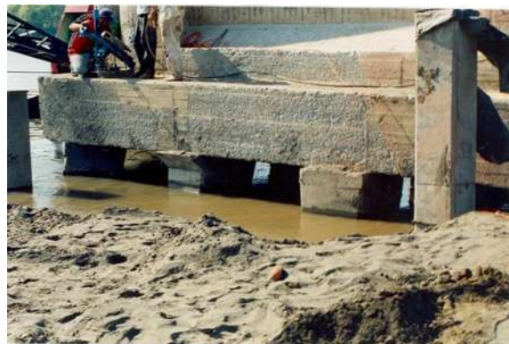
Figura 2.19. Reconstrucción de la zapata de la pila número 9. Pueden observarse los pilotes de 80x80 cm y la conexión deficiente.
