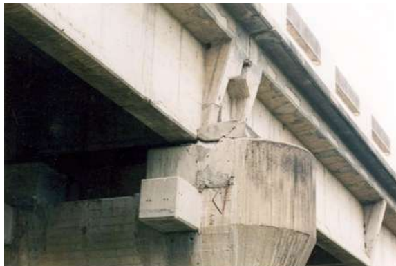
Figura 2.36. Fractura de los topes sísmicos
