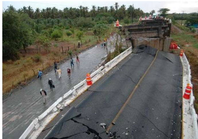
Figura 2.54. Vista superior del colapso del puente El Cuajilote tomada desde uno de los accesos [2.54].
