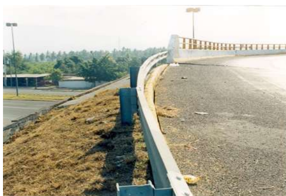
Figura 2.45. Asentamiento de acceso y corrimiento del bordillo.
