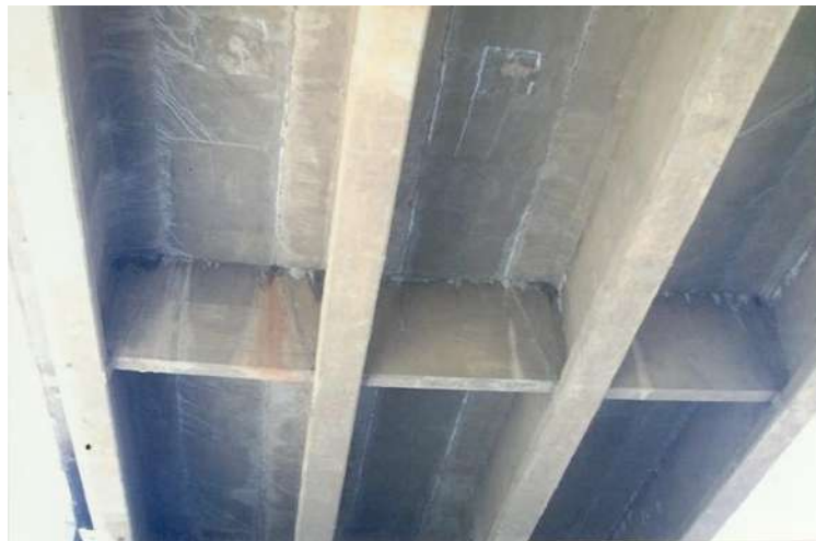
Figura 2.23. Daño de la superestructura del puente Nexpa.
