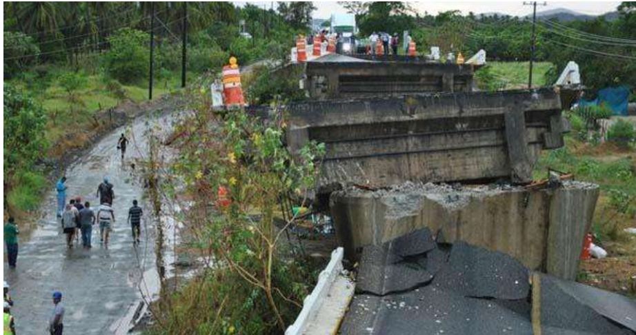
Figura 2.55. Detalle del colapso de la superestructura y la pila central del puente El Cuajilote [2.55].
