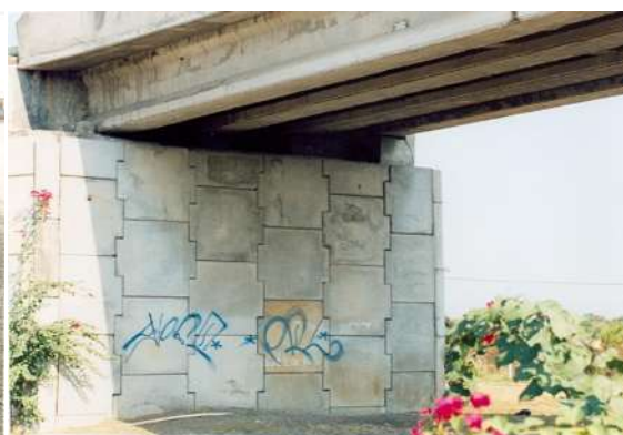
Figura 2.46. Fractura del tope sísmico en el estribo.
