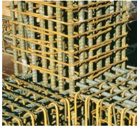
Figura 3.7. Congestionamiento del acero de refuerzo en el armado de columnas y uniones con otros elementos [14].
