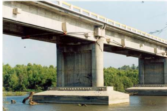
Figura 2.15. Vista general de la pila no. 12. Aparentemente esta pila sufrió un asentamiento.
