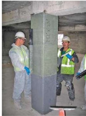
Figura 6.7. Encamisado con fibra de vidrio en una columna interior de un edificio [34].
