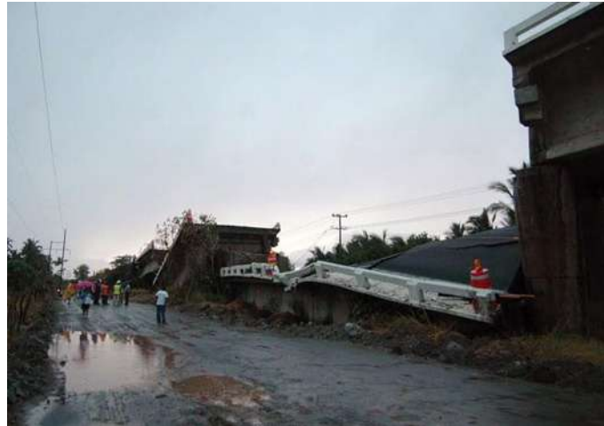
Figura 2.53. Vista lateral de los dos claros del puente El Cuajilote que colapsaron durante el sismo del 08 de mayo de 2014 [2.53].
