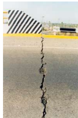
Figura 2.42. Fractura de la carpeta como consecuencia del movimiento transversal de la superestructura.
