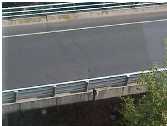
Figura 2.48. Agrietamiento en el segundo piso del periférico, D.F.
