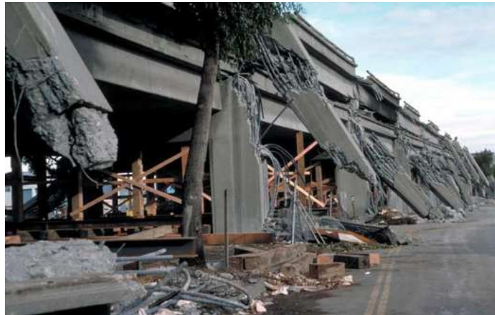
Figura 1.5. Viaducto Cypress, Oakland Ca., colapsado durante el sismo de Loma Prieta en 1989 [1.5].
