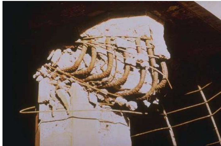
Figura 1.12. Columna de un puente en la autopista interestatal cruce 5-210 bajo el sismo de San Fernando [1.12].
