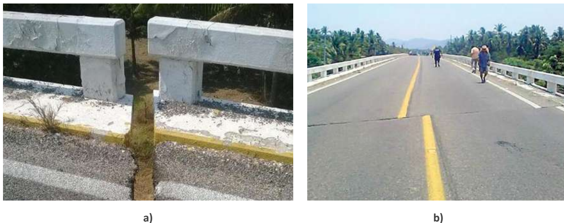
Figura 2.51. Desfase del puente El Cuajilote en el km 111 de la carretera Acapulco-Zihuatanejo: a) Vista longitudinal y; b) vista transversal [2.51].
