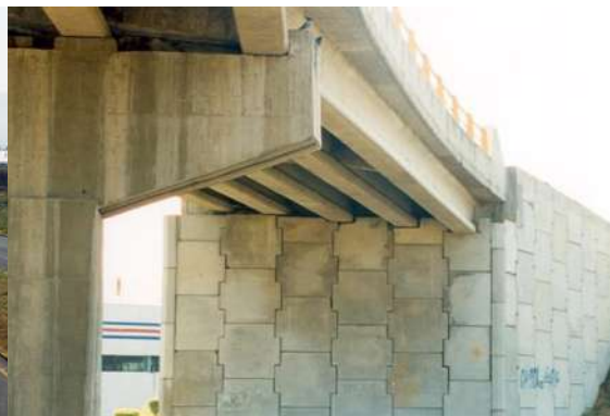
Figura 2.44. Fractura del tope sísmico en la pila.
