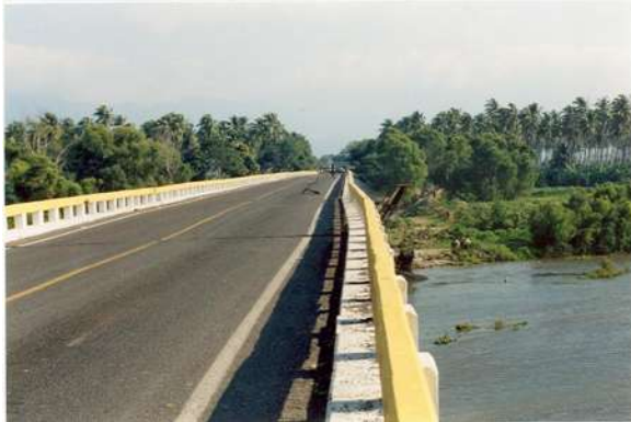
Figura 2.14. Vista del desplazamiento transversal de la superficie del puente en dirección Playa Azul.
