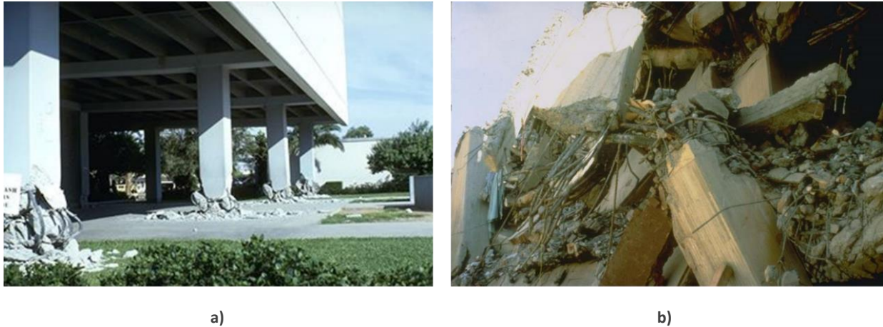
Figura 1.13. a) Falla de las columnas del edificio de servicios de Imperial Valley en el sismo de 1979. b) Detalle de columna del Hospital Juárez después del sismo de México en 1985 [1.13].
