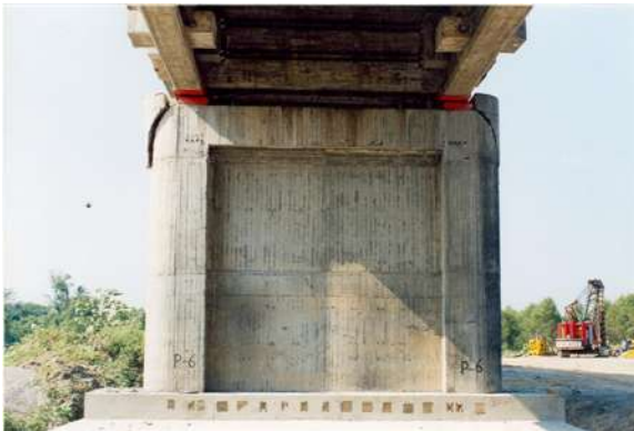
Figura 2.16. Fractura de los topes antisísmicos de la pila número 6.
