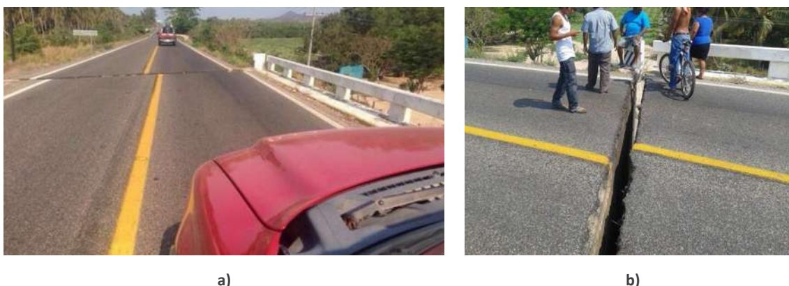
Figura 2.50. Desfase del puente Las Tortugas en el km 114 de la carretera Acapulco-Zihuatanejo: a) Vista longitudinal y; b) vista transversal [2.50].
