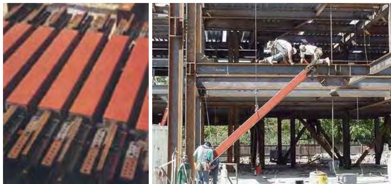
Figura 2.4.-A la izquierda amortiguadores restringidos contra pandeo y a la derecha colocación en un edificio del contraviento.
