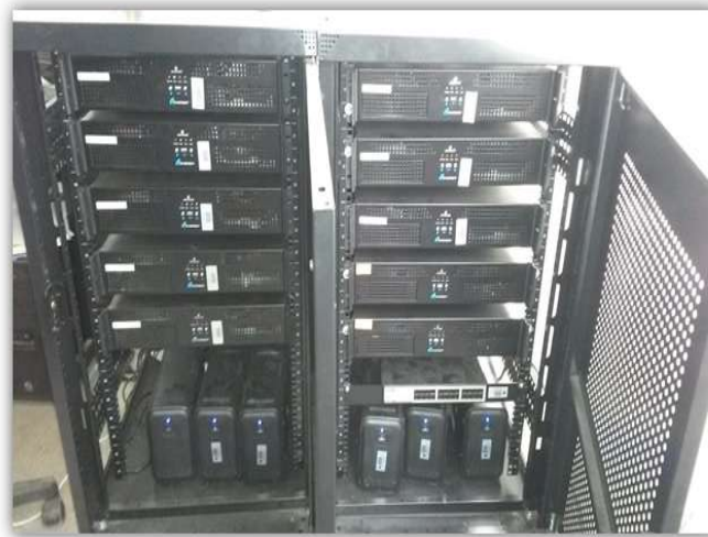
Figura 3.14. Estaciones de trabajo del cluster de cálculo construido para el trabajo de optimización
