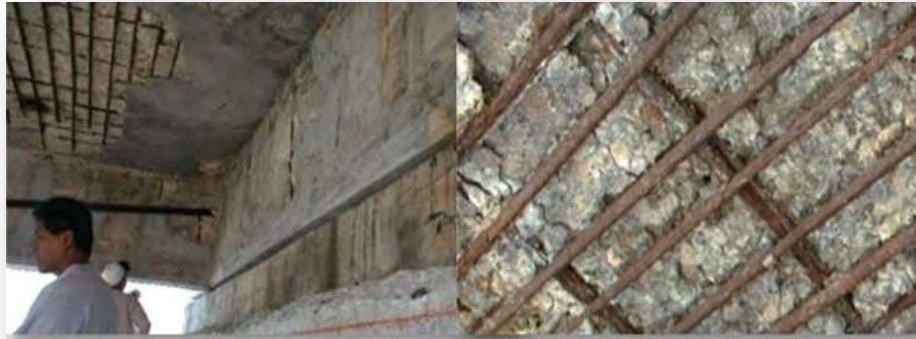
Figura 24. Corrosión severa de la armadura en una losa de un puente
