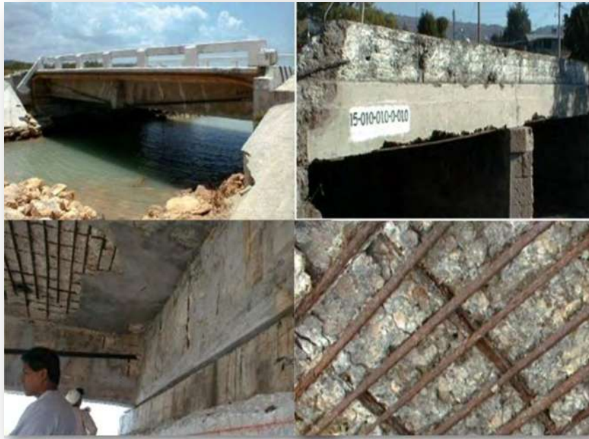
Figura 12. Problemática que presentan algunos puentes debido al proceso de corrosión en el que están envueltos [www.imt.mx].
