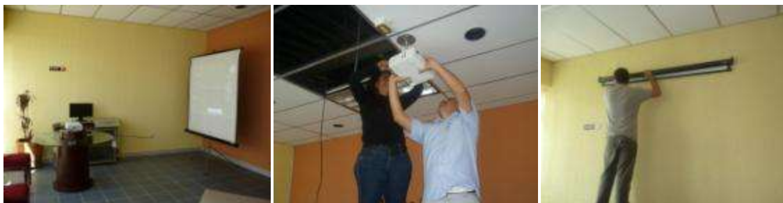
Fig. 3.11. Trabajos improvisados y de poca calidad que se van mejorando con el tiempo 53
