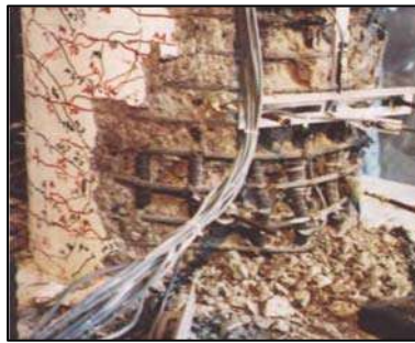
Figura 2. 9 Nivel de daño V (Hose et al. 1997)
