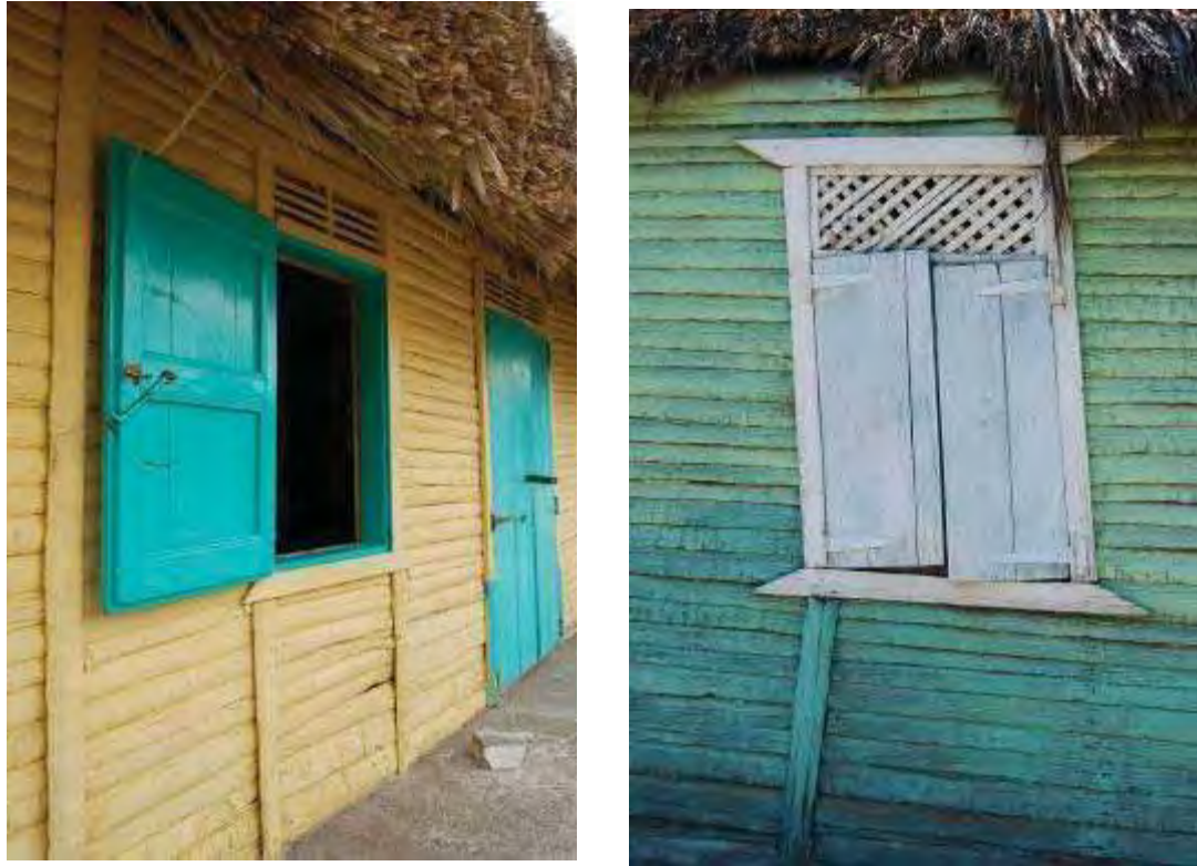
Figura 156. Detalles de ventiladores en Sabana Buey y en Pueblo Viejo de Azua. Fotos: EPV. 2007 y 2008.
