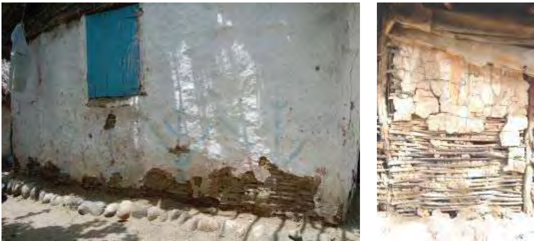
Figura 133. Casas de bajareque con muestras de deterioro del embarrado. A la derecha puede verse un embarrado sin boñiga. Fotos: EPV
