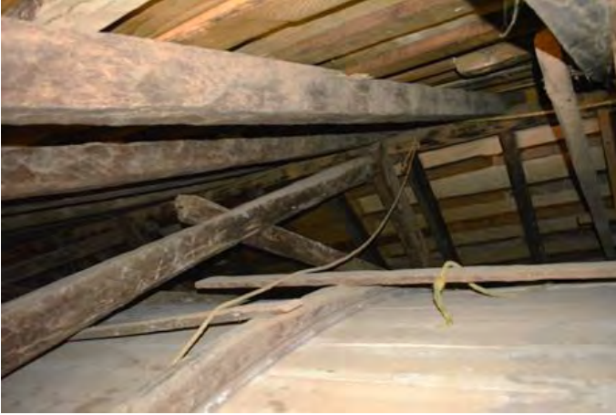
Figura 18: San Francisco Uricho. Cubierta combinada entre caballete con pares y nudillos. Fotografía: Armando Alexis Aguilar Ayala.
