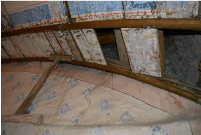
Figura 17: Santa María de la Natividad Arocután. Condiciones físicas de la bóveda Fotografía: Armando Alexis Aguilar Ayala.
