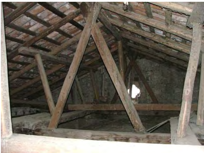
Figura 19: San Francisco Ihuatzio. Cubierta de caballete, largueros, puntales y tijeras auxiliares. Fotografía: Armando Alexis Aguilar Ayala.
