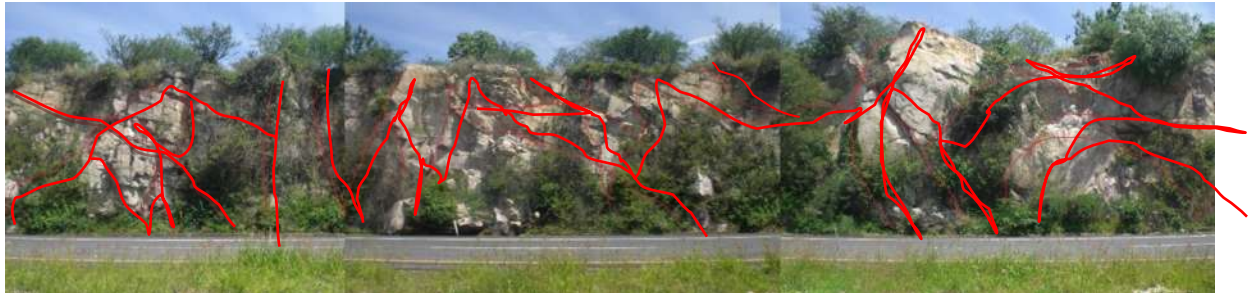
Figura 4.27.- En rojo se muestran las principales discontinuidades del talud 2 Norte.
