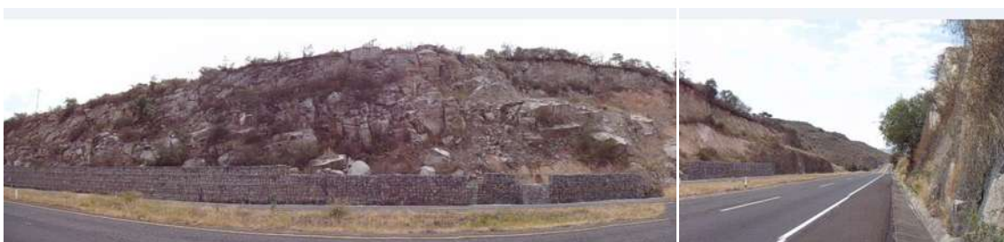
Figura 5.1. Muro de Gavión con necesidad de refuerzo y Limpieza en su zona interior (opcion1)
