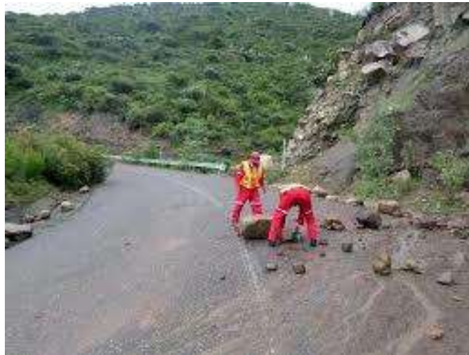
Figura 2.15.- Zonas inestables del talud con caída de rocas.
