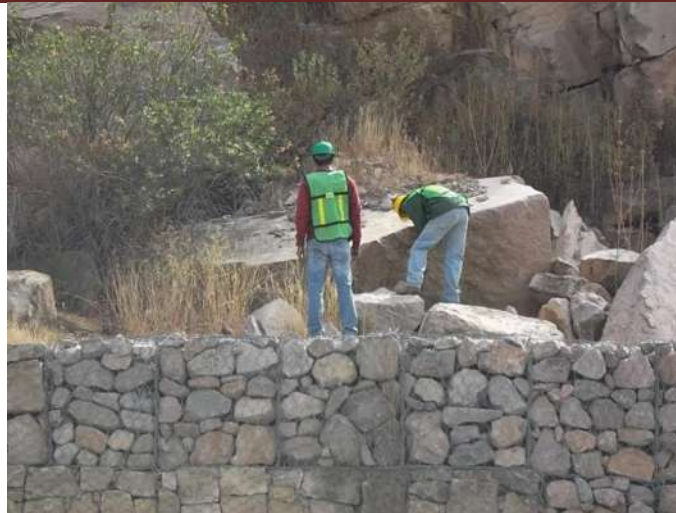
Figura 2.33.- Se observa que este talud necesita una limpieza en la parte interna del muro de gavión, se encuentra lleno de material de caída y se está generando un empuje sobre el muro.
