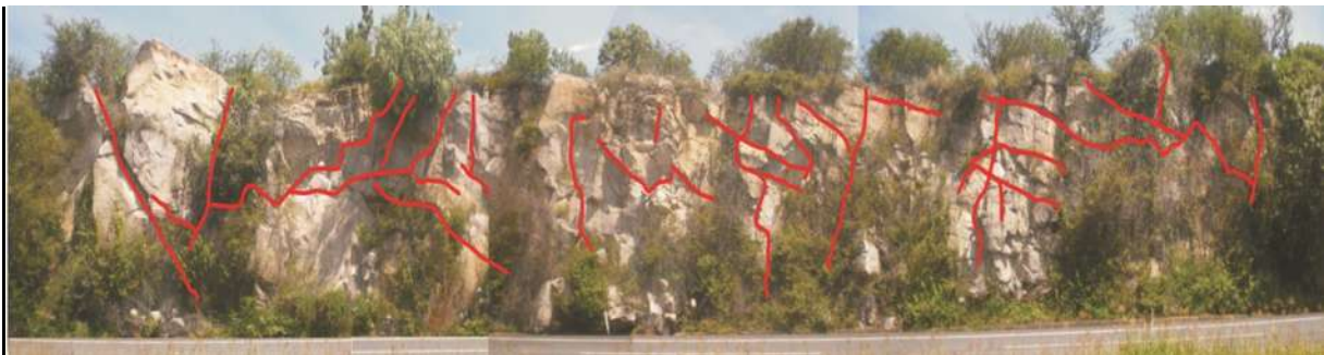
Figura 4.26.- En rojo se muestran las principales discontinuidades del talud 1 Oeste.
