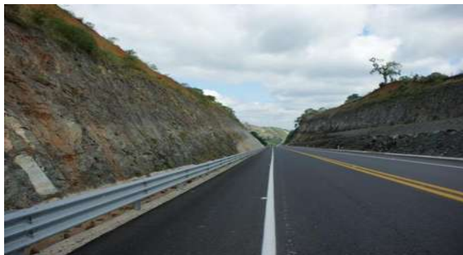
Figura 2.17.- Ejemplo de un talud carretero en la Autopista México-Tuxpan donde existe un problema de inestabilidad.
