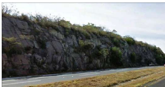
Figura 2.30.- Talud del km 260+000 (lado Norte), donde se observa que está muy propenso a sufrir movimientos de rocas, aunque este recubierto con malla.
