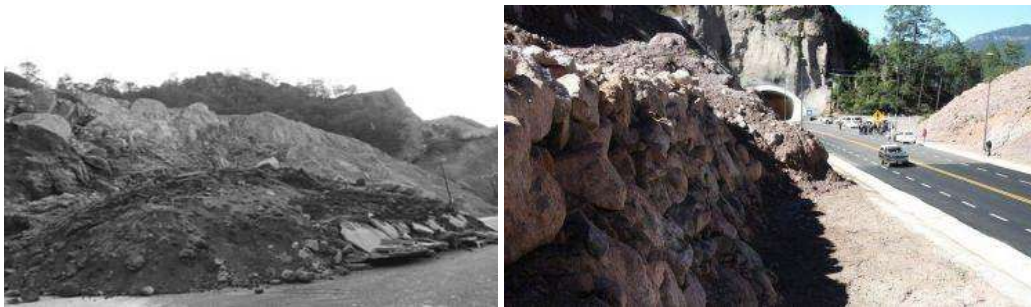
Figura 2.26.- En la imagen de la izquierda se muestra el deslizamiento de roca que sufrió un talud de la autopista Durango-Mazatlán y en la imagen de la derecha se observa el muro de Gavión que se levantó para darle estabilidad al talud.
