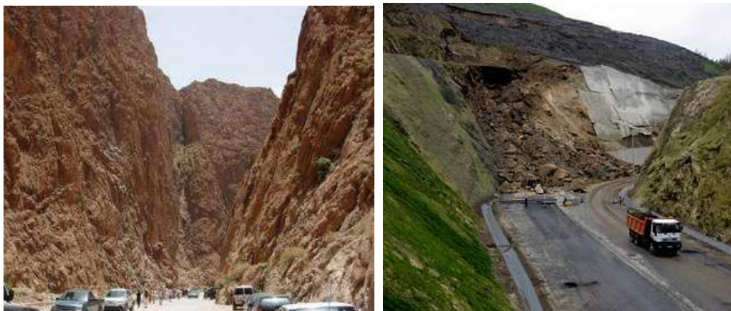
Figura 2.10.- Ejemplo de grandes taludes rocosos en la unión americana, con inminente peligro de derrumbes y caída de rocas sobre los vehículos que circulan.
