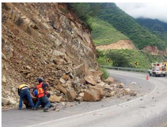
Figura 2.14.- Talud en la vía Xichú con desprendimientos de roca.
