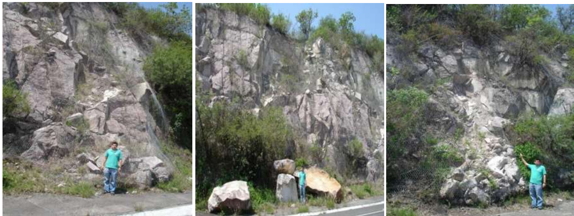
Figura 2.32.- Se observa que en este talud la malla ya no soporta el empuje de los bloques que ejercen y se está rompiendo cada vez más.
