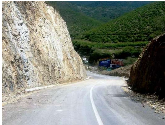
Figura 2.13.- Taludes inestables en la carretera Xichú- Atarjea.
