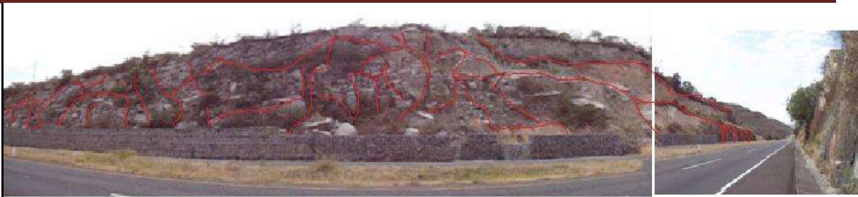
Figura 4.25.- En rojo se muestran las principales discontinuidades del talud 1 Este.
