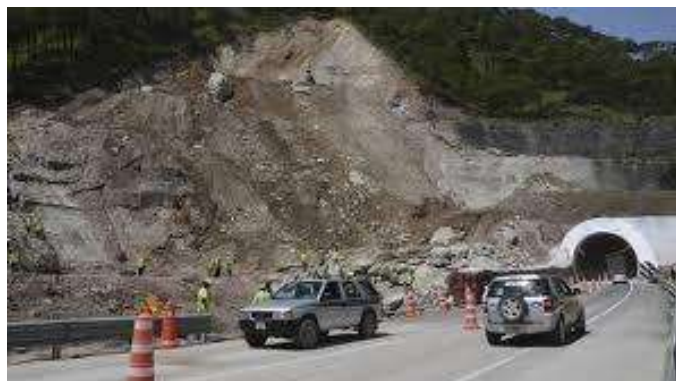
Figura 2.24.- Talud con deslizamiento de rocas que impidió la circulación después de la tormenta Tropical Manuel.
