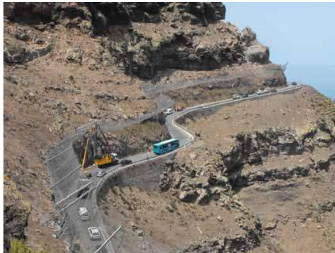
Figura 2.4.- Barrera dinámica para la protección entre Agaete y La Aldea.
