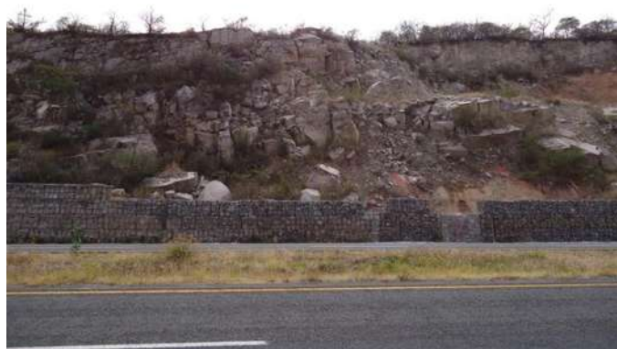
Figura 2.31.- Talud del km 261+00(lado este), donde se observa que ha tenido problemas y se han construido alternativas de solución para estabilizarlo.
