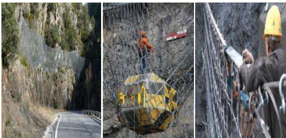
Figura 3.21.- Barreras dinámicas para contener grandes bloques de roca.
