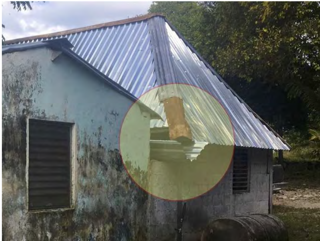
Figura 3.15. Canaleta para desalojo de aguas pluviales
