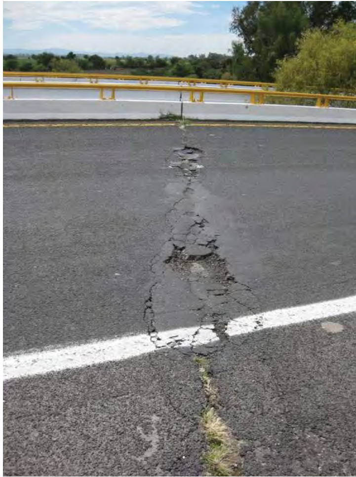
Figura 4.5 Junta de dilatación tapada por el recarpeteo de asfalto
