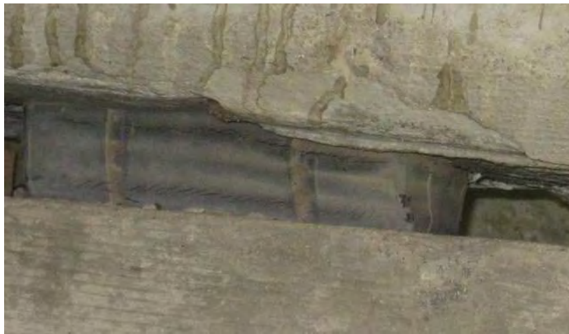
Figura 4.8 Apoyo con capacidad de carga deficiente
