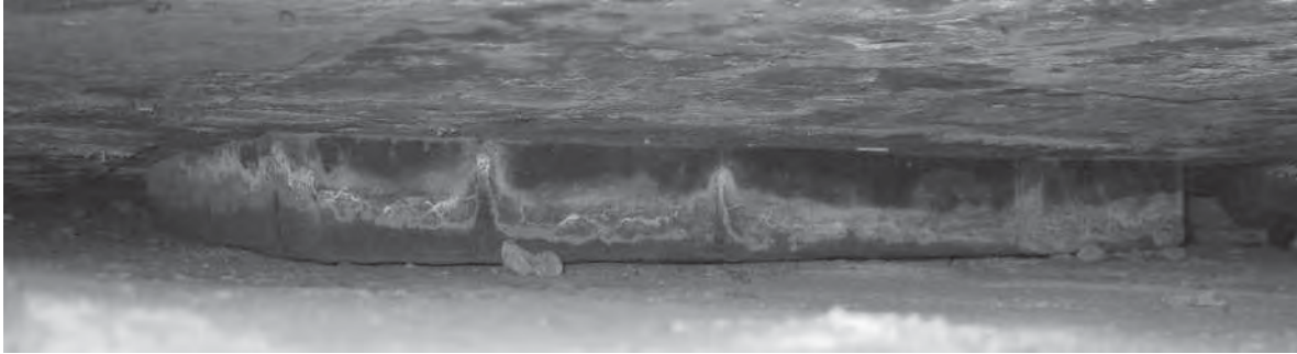
Figura 4.7 Apoyo con presencia de humedad y óxido
