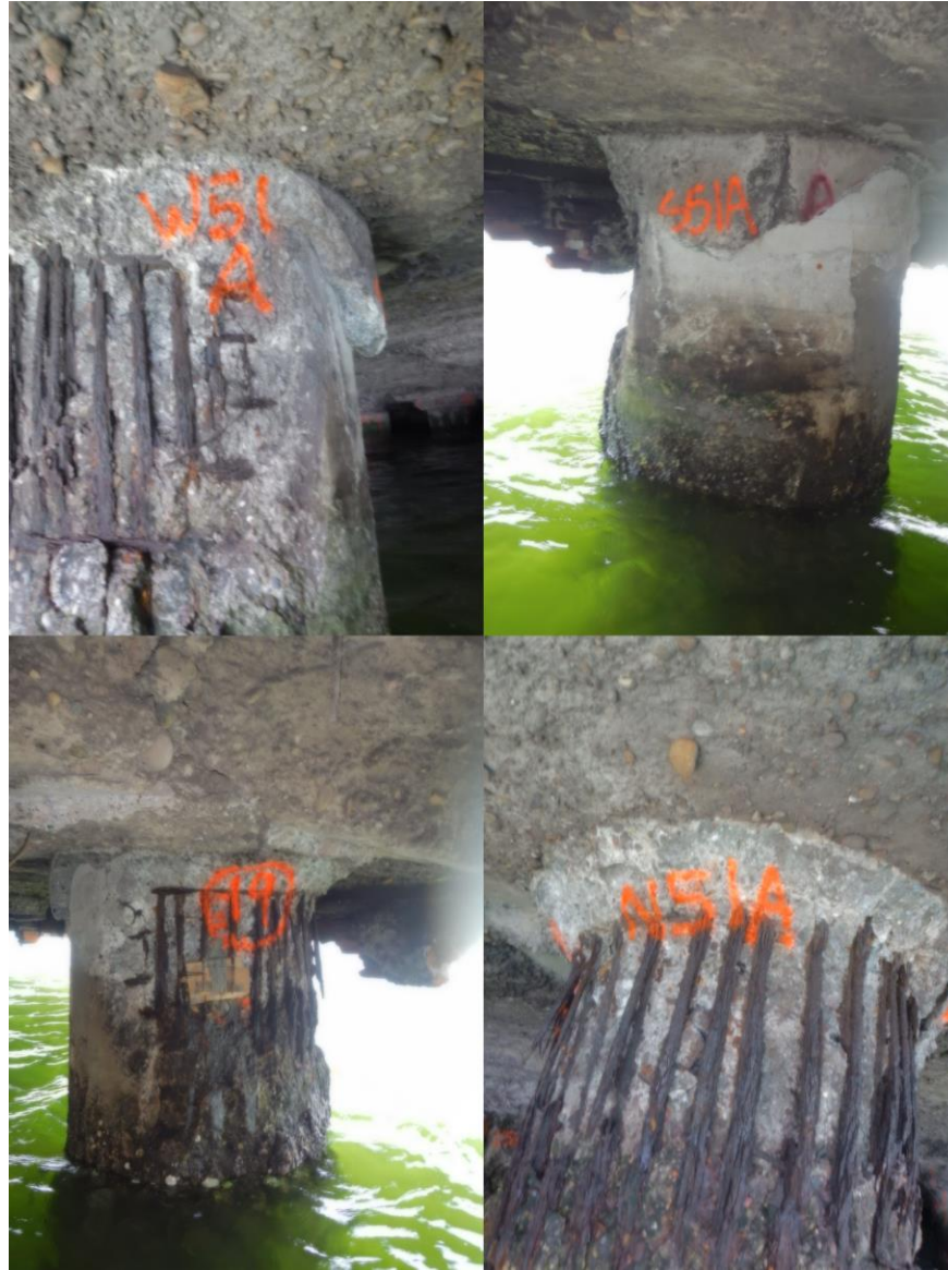
Fig. 84. M1 Pila E51A, reportada con nivel de daño 6 PF 3-4CCPa (tres o cuatro caras dañadas con pérdida de acero).
