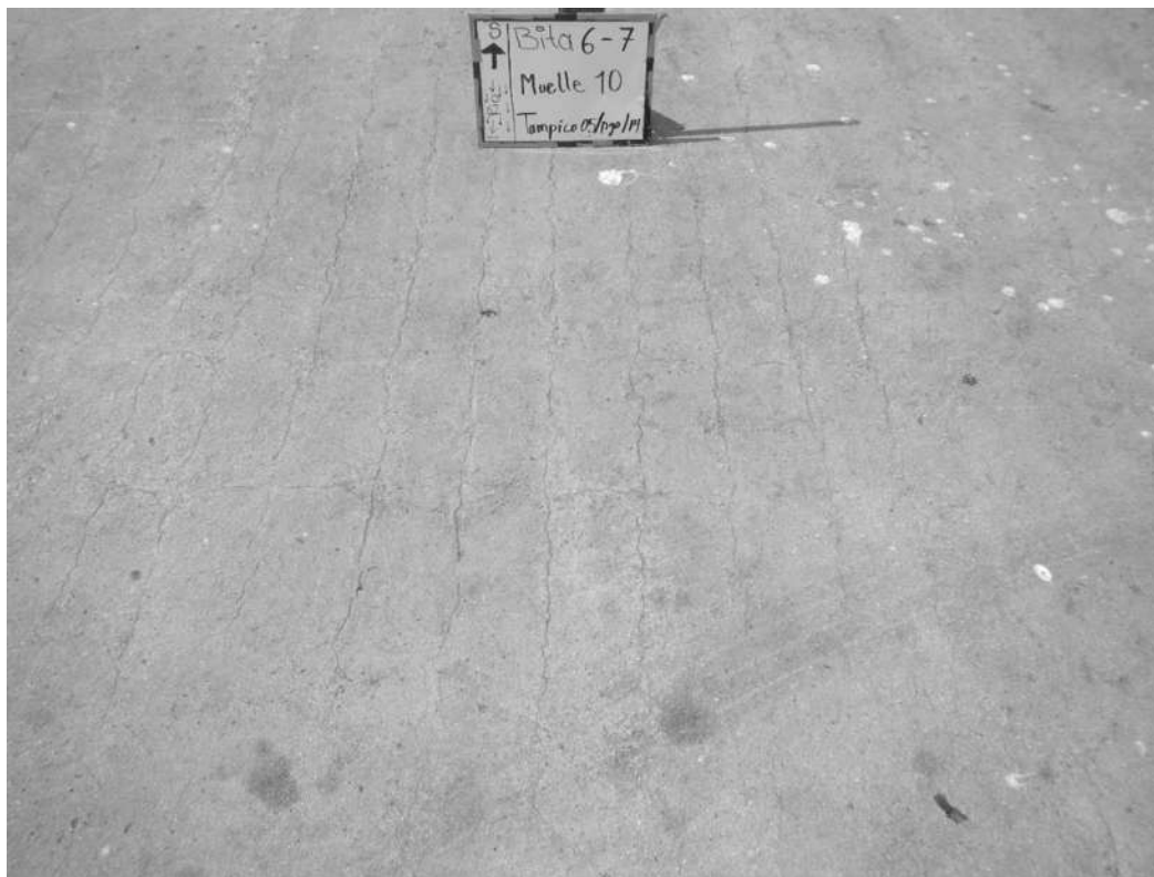
Fig. 55. LR 55Norte M10, reportada con un nivel de daño 3 (más de 1\text{m}^2 de daño con pérdida de acero).
