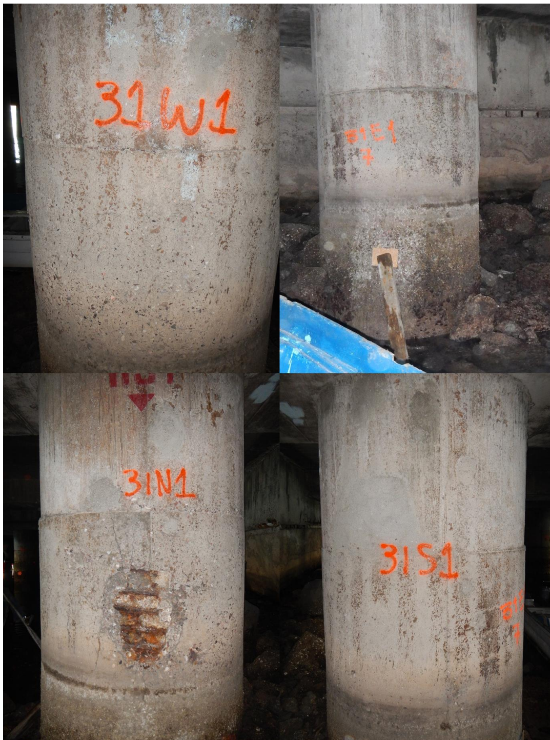
Fig. 47. Pila 31E1, reportada con nivel de daño PF 3-4CCPa (tres o cuatro caras dañadas con pérdida de acero).
