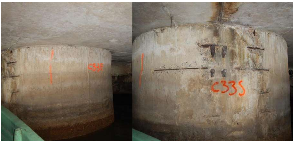
Fig. 58. Pila C33W M2, reportada con un nivel de daño 4 PD ICCPa (una cara dañada con pérdida de acero).
