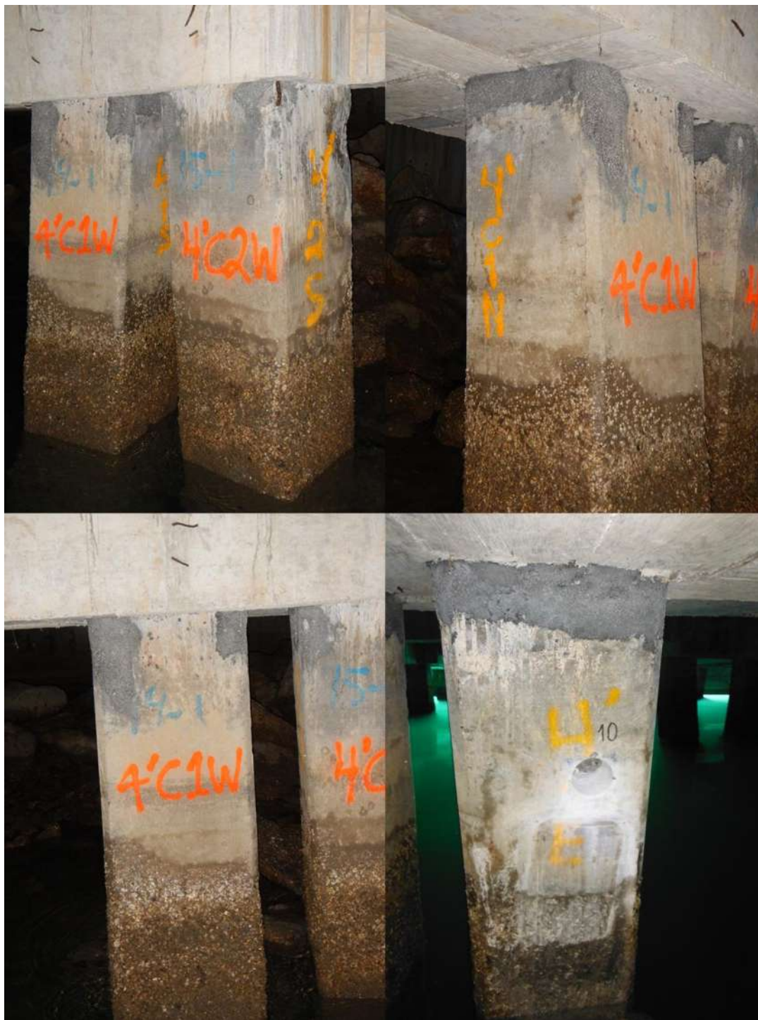
Fig. 88. Pilote 4'C1E, reportado sin daños.
