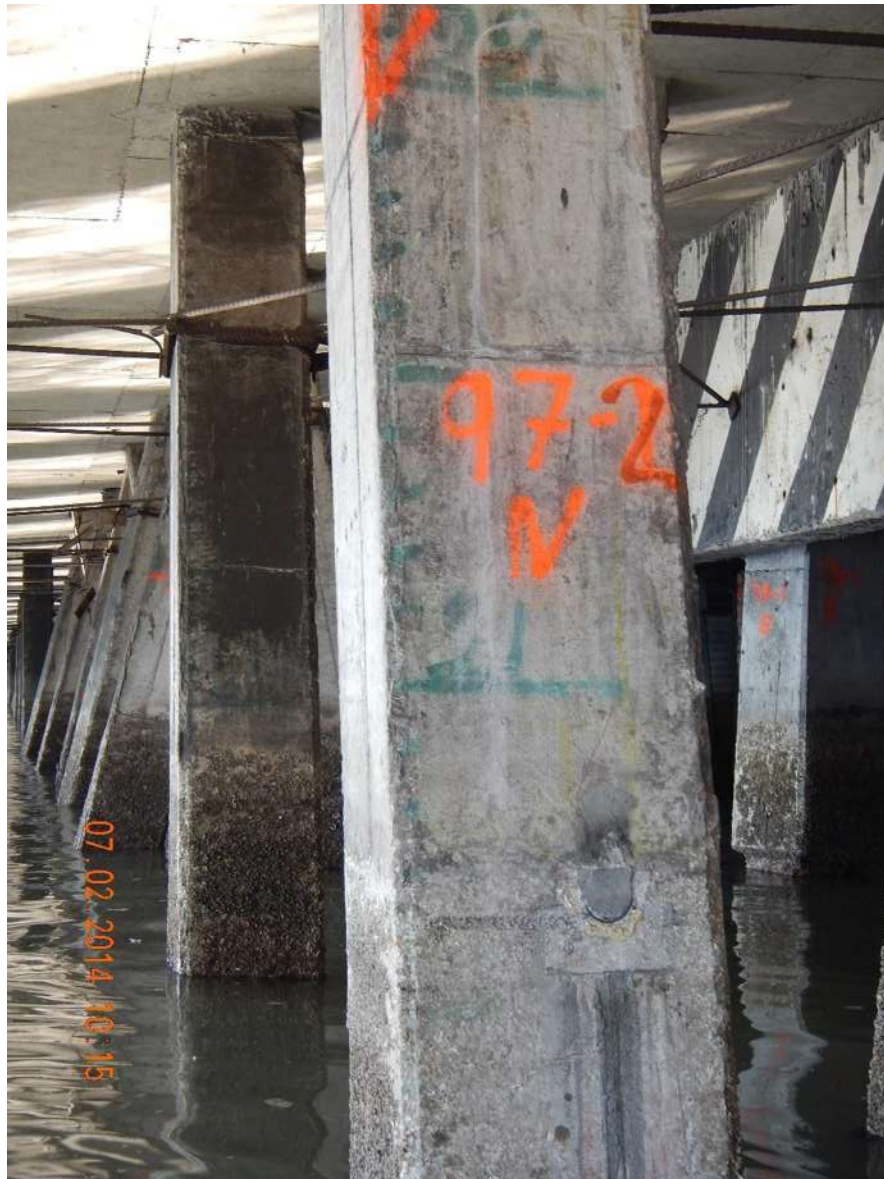
Fig. 43. Pilote 97N2, reportado sin daño.
