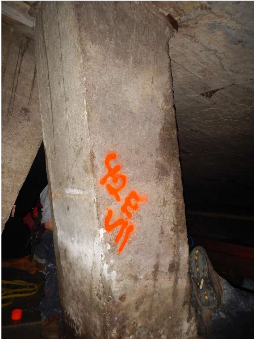
Fig. 60. BB pilote 42W7 VII, reportado con un nivel de daño 1 PA 1CSPa (una cara dañada sin pérdida de acero).
