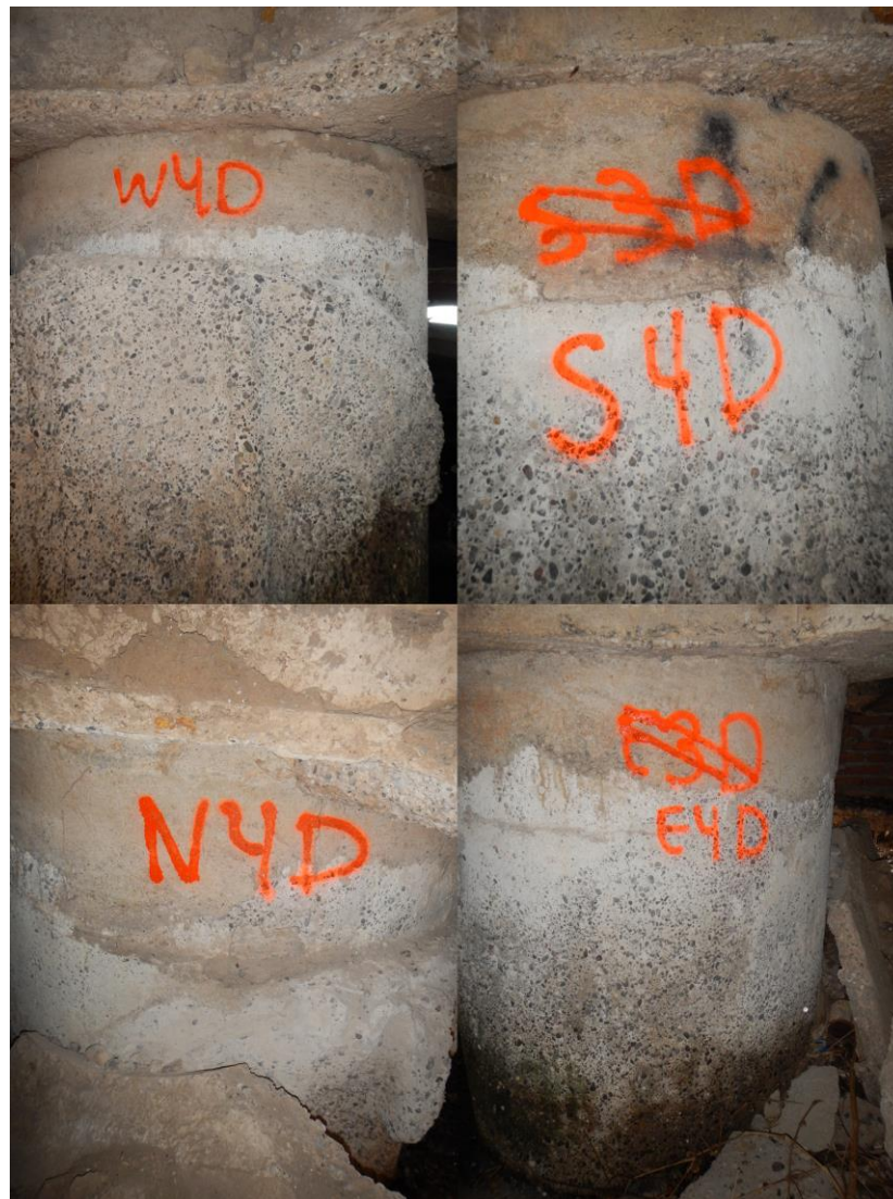
Fig. 76. Granos Pila S4D, reportada con nivel de daños 3 PC 3-4CSPa (tres o cuatro caras sin pérdida de acero).
