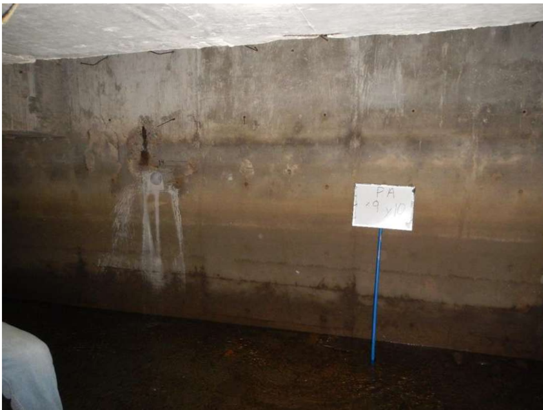
Fig. 94. CP A/9-10, reportada con nivel de daño 6 NB 1mCPa (más de 1m 2 de concreto dañado con pérdida de acero).
