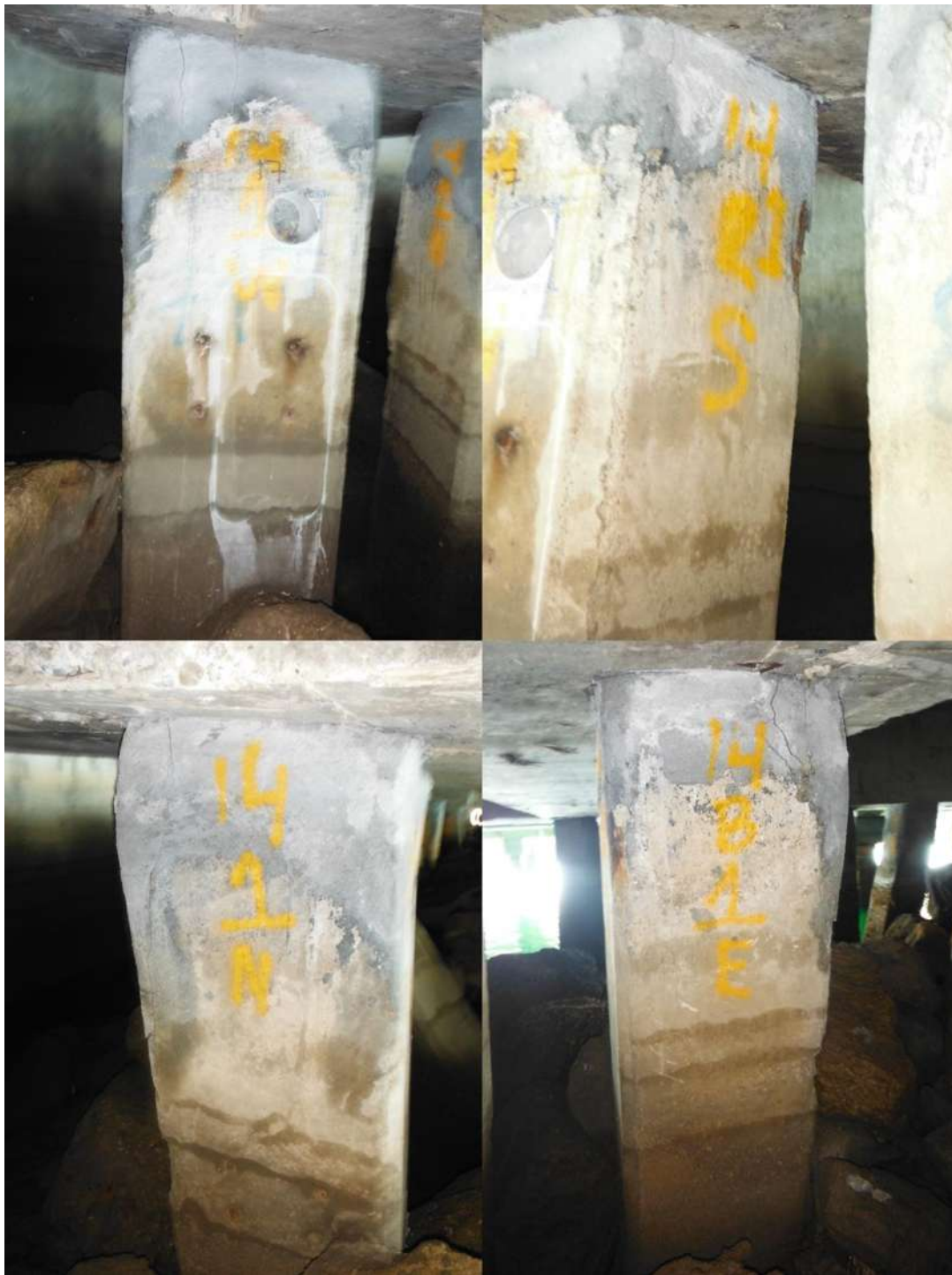
Fig. 95. Pilote 14B1W, reportado con un nivel de daño 6 PF 3-4CCPa (tres o cuatro caras dañadas con pérdida de acero).
