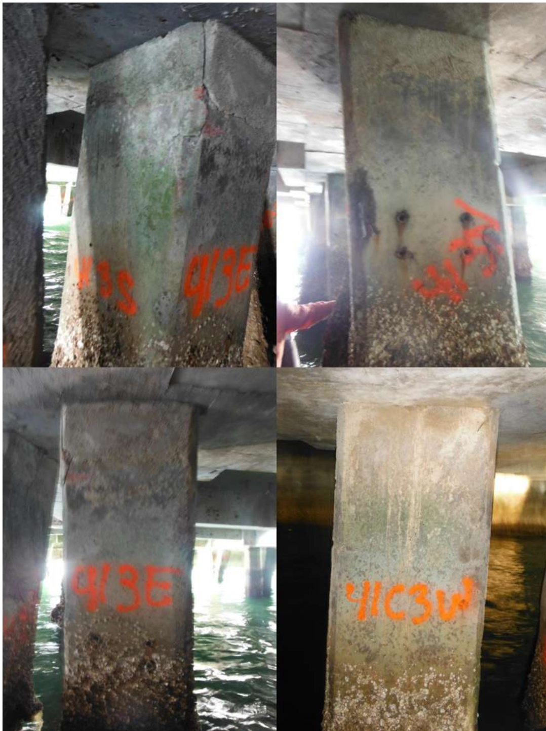
Fig. 90. Pilote 41C3W, reportado con nivel de daño 3 PC 3-4CSPa (tres o cuatro caras dañadas sin pérdida de acero).
