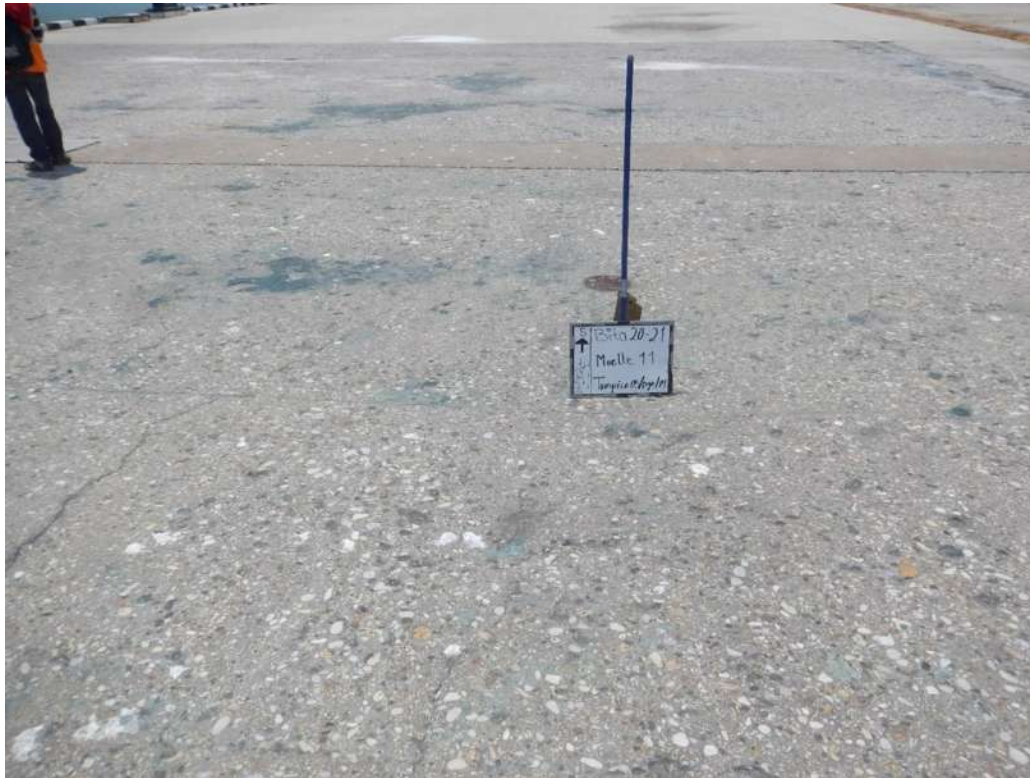
Fig. 54. LR 48Este M11, reportada con un nivel de daño 3 (más de 1\text{m}^2 de daño con pérdida de acero).
