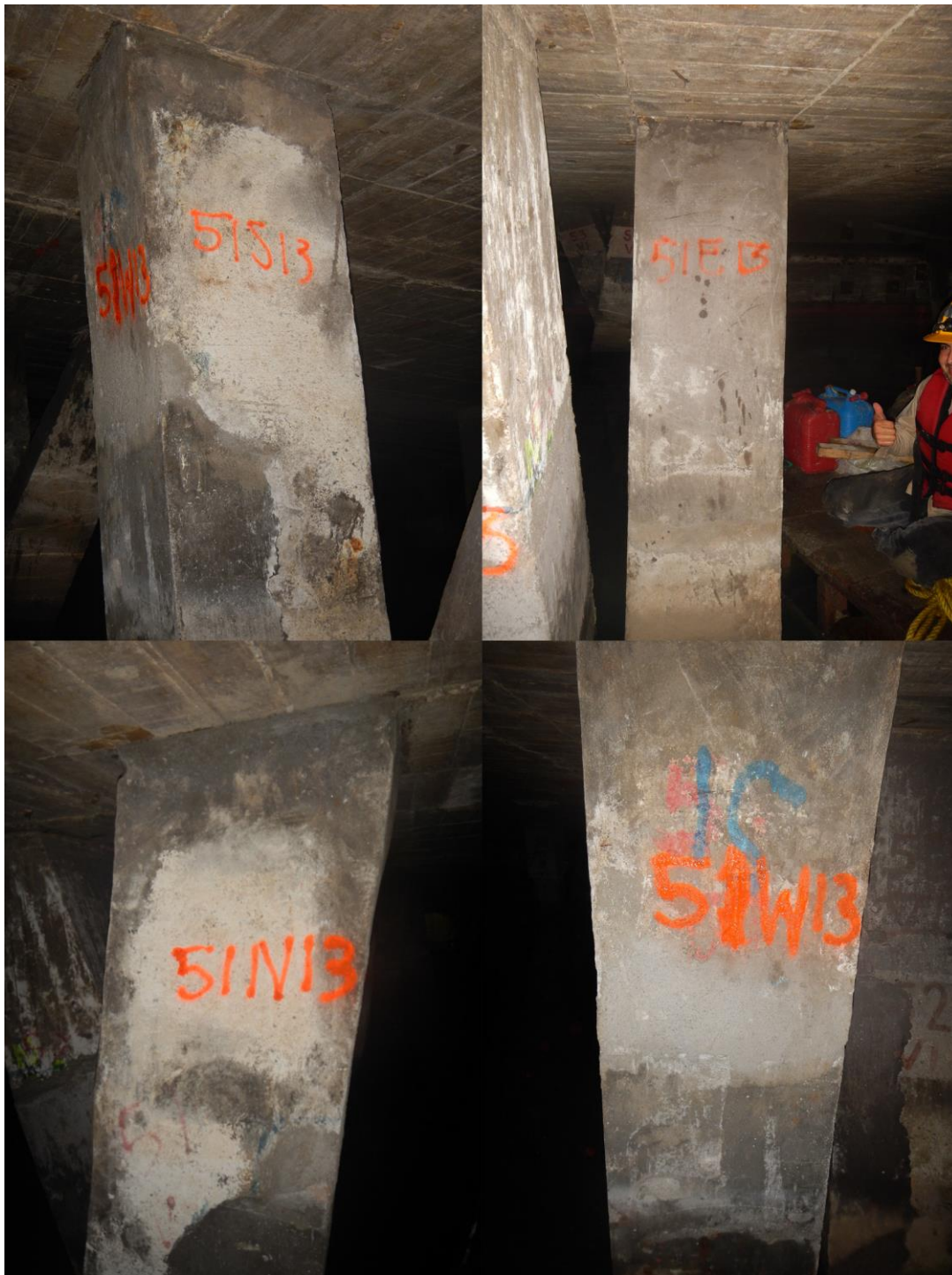
Fig. 70. BC pilote 51E13 XIII, reportada con un nivel de daño 6 PF 3-4CCPa (tres o cuatro caras con pérdida de acero).
