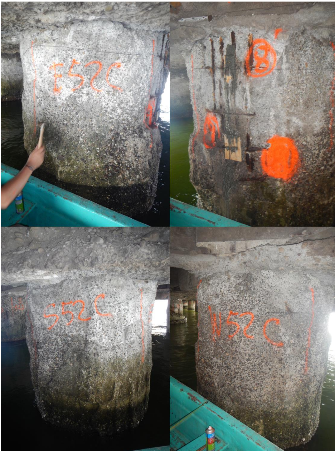
Fig. 86. Granos Pila N52C, reportada con nivel de daño 6 PF 3-4CCPa (tres o cuatro caras dañadas con pérdida de acero).
