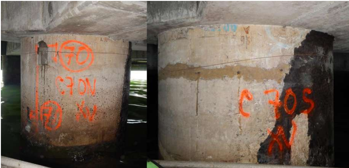
Fig. 64. BD pila 70CS M15, con nivel de daño reportado de 2 PB 2CSPa CP (dos caras dañadas sin pérdida de acero y concreto pobre).
