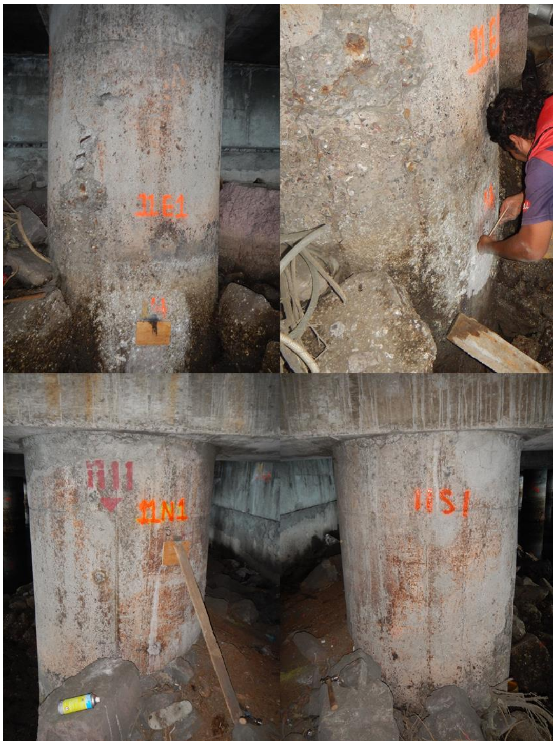
Fig. 44. Pila 11E1, reportada con nivel de daño PB 2CSPa (dos caras dañadas sin pérdida de acero).
