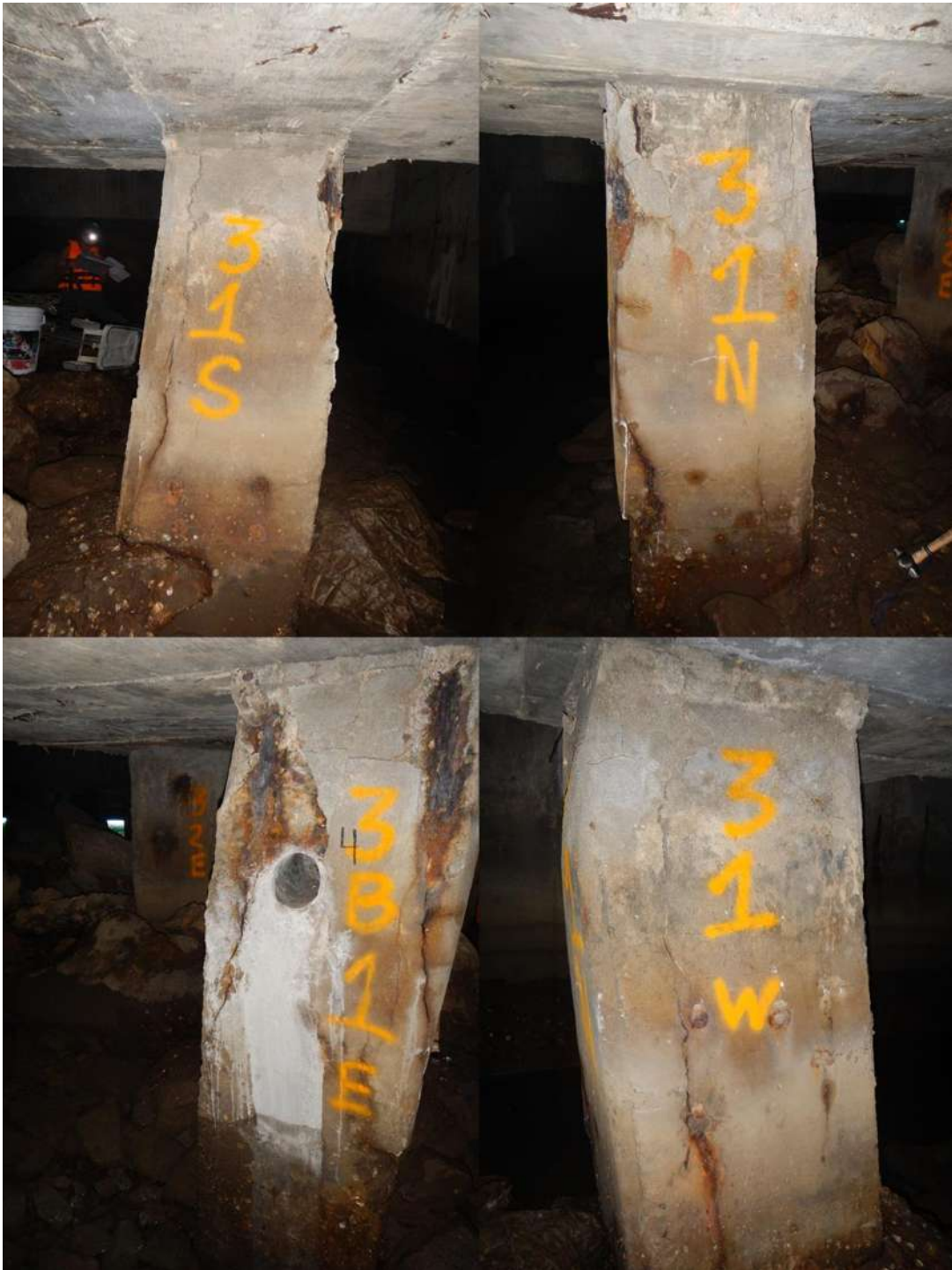
Fig. 97. Pilote 3B1E, reportado con nivel de daño 6 PF 3-4CCPa (tres o cuatro caras dañadas con pérdida de acero).
