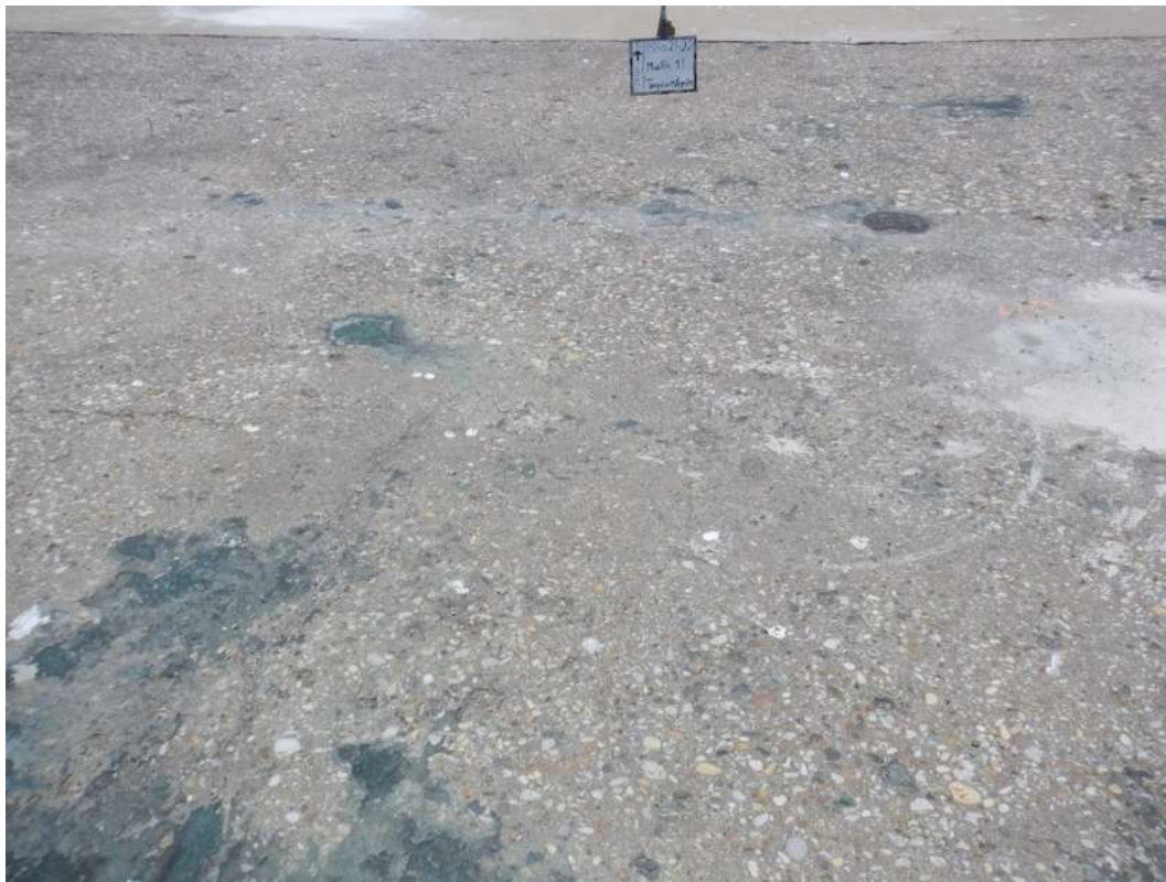
Fig. 53. LR 46Sur M11, reportada con nivel de daño 3 (más de 1m 2 de daño con pérdida de acero).
