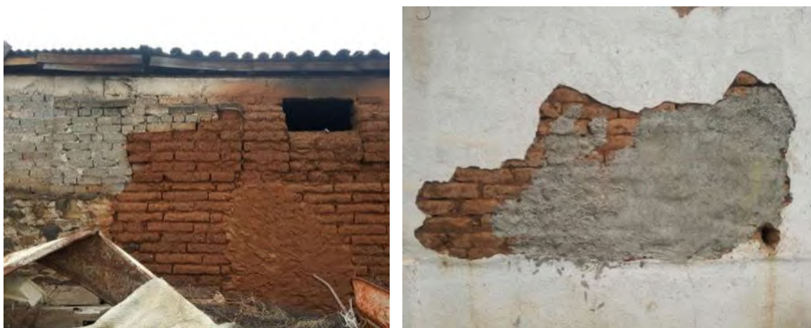
Figura 4.2. Construcciones de adobe con intervenciones no compatibles: (a) Vivienda en Tzintzuntzan, Michoacán, México; (b) Muro perimetral en Quiroga, Michoacán, México. Fotografías: (A. Sánchez-Calvillo, 2020).
