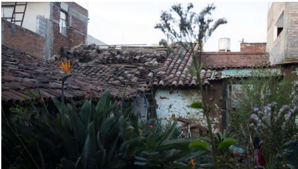
Figura 3.89. Estado de conservación de la vivienda AR14. Fotografía: (A. Solís-Sánchez, 2021).
