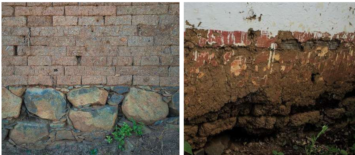
Figura 3.18. Sistemas de cimentación en viviendas de adobe: (a) Cimentación y sobrecimentación tradicional con piedra volcánica en Tzintzuntzan, Michoacán, México; (b) Pérdida y disgregación por humedad de capilaridad en vivienda de Ario de Rosales, Michoacán, México. Fotografías: (A. Sánchez Calvillo, 2020; 2021).
