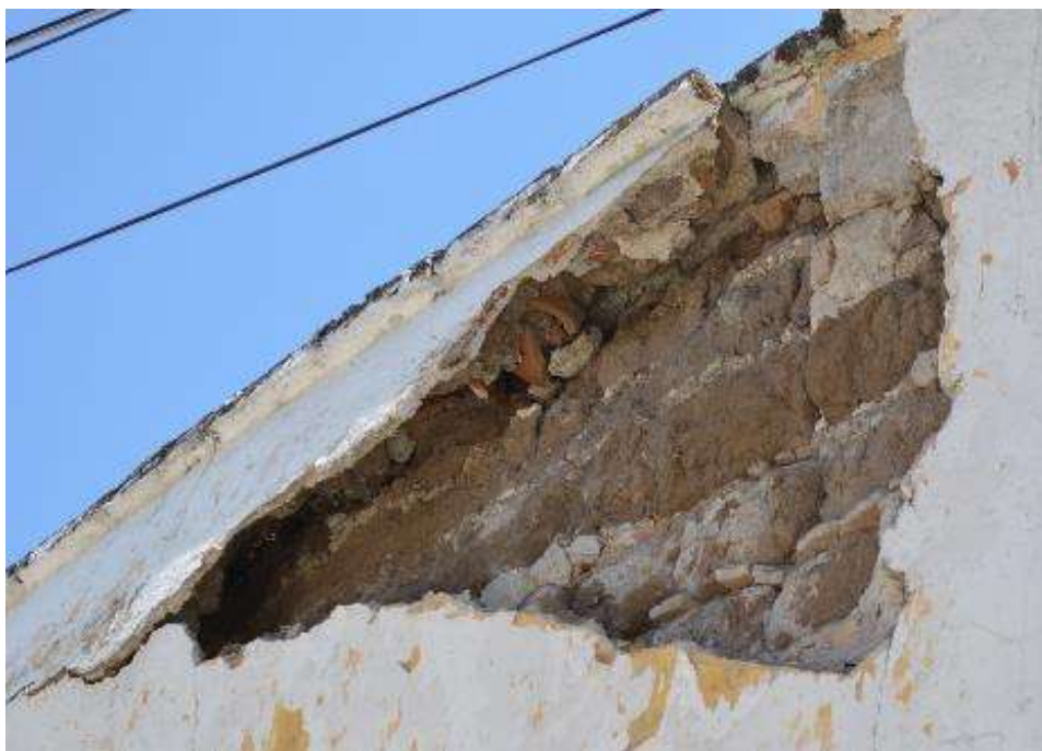
Figura 2.45. Separación de aplanado de cemento tras el Sismo de Puebla de 2017. Fotografía: (A. Sánchez-Calvillo y E. G. Navarro-Mendoza, 2018).
