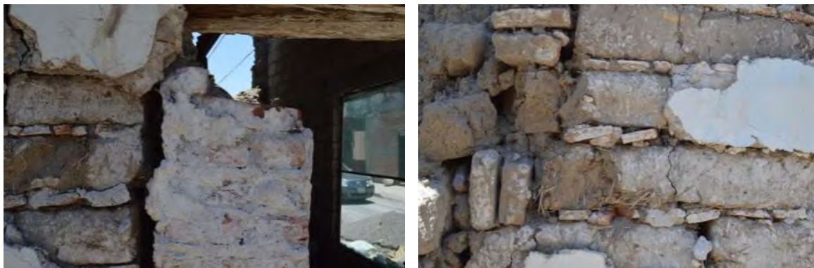
Figura 3.5. Estructuras de adobe afectadas en Jojutla de Juárez. Fotografías: (E. G. Navarro-Mendoza y A. Sánchez-Calvillo, 2018).
