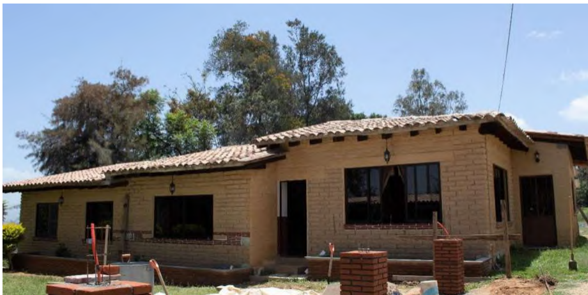
Figura 3.88. Vivienda SPE09 con elementos de refuerzo. Fotografía: (I. Velasco-Hernández, K. L. Salvador-Alcalá, 2020).
