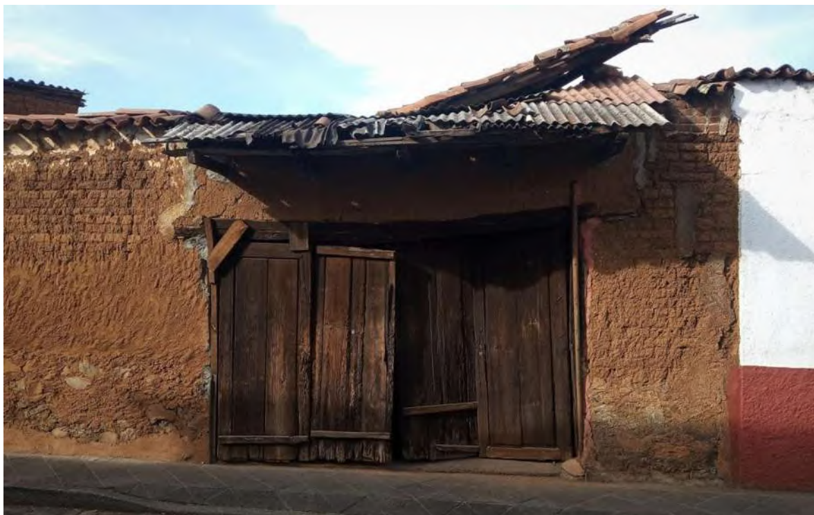
Figura 2.1. Vivienda abandonada en San Andres Coapa, Michoacán México. Fotografía: (A. Sánchez-Calvillo, 2021).
