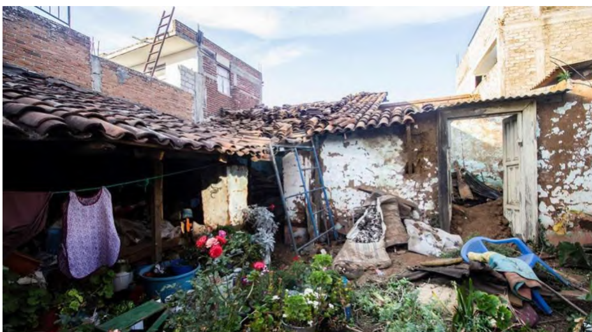
Figura 3.33. Vivienda en grave estado de deterioro en Ario de Rosales, Michoacán, México. Fotografía: (A. Solís-Sánchez, 2021).
