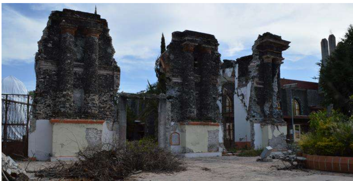
Figura 1.25. Daños graves en la Iglesia de San Miguel de Jojutla. Fotografías: (E. G. Navarro-Mendoza y A. Sánchez-Calvillo, 2018).
