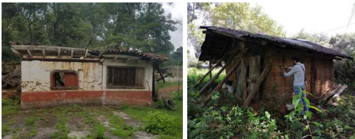
Figura 2.64. Viviendas abandonadas a las afueras de Ario de Rosales, Michoacán, México. Fotografías: (A. Sánchez-Calvillo, 2020).
