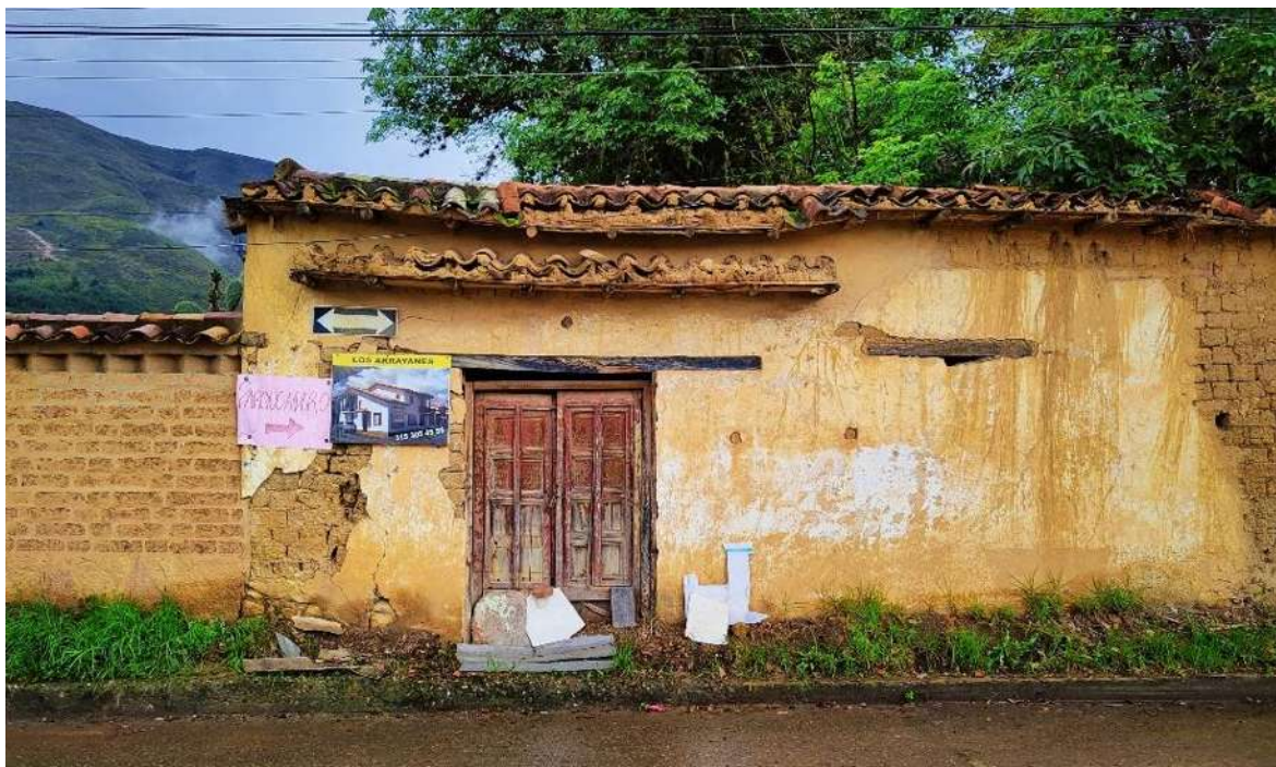
Figura 0.2. Antiguo inmueble de adobe abandonado en la localidad de Villa de Leyva, Boyacá, Colombia. (Fotografía: A. Sánchez-Calvillo, 2021).
