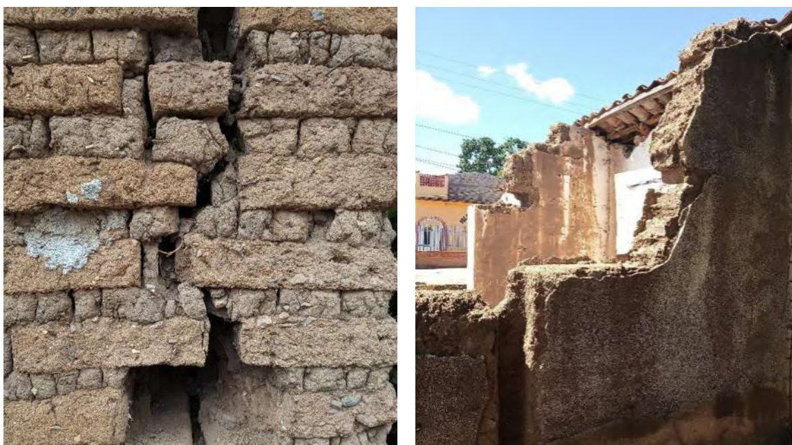
Figura 3.4. Daños producidos en viviendas de adobe tras el terremoto de Chiapas de 2017 (a) Grieta en muro de vivienda de San Andrés Hueyapan, Oaxaca; (b) Colapso de muro en Jiquipilas, Chiapas. Fotografías: (A. Sánchez-Calvillo, 2019).
