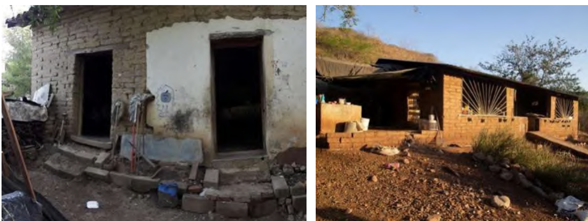
Figura 3.28. Ejemplos de desalineación de aberturas en los casos de estudio: (a) Apertura de puerta secundaria en vivienda de Copainalá, Chiapas, México; (b) Muro con vanos excesivos en vivienda de Santa Cruz de Morelos, Michoacán, México. Fotografías: (L. J. Díaz-Juárez, 2020; A. Solís-Sánchez, 2021).
