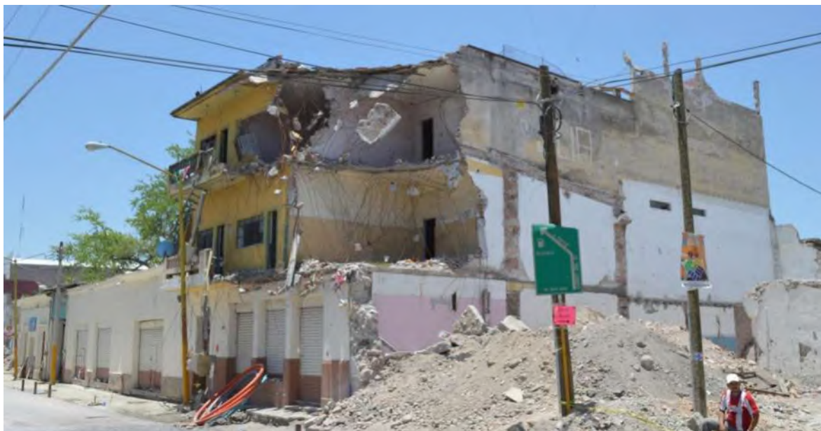
Figura 2.40. Daños en los inmuebles del centro de Jojutla. Fotografía: (A. Sánchez-Calvillo y E.G. Navarro-Mendoza, 2018).
