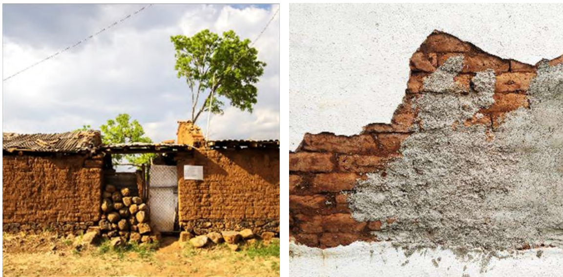
Figura 2.2. Factores de deterioro de la arquitectura de tierra: (a) Vivienda abandonada en San Nicolás Obispo, Michoacán; (b) Ejemplo de mala intervención constructiva en Quiroga, Michoacán. Fotografías: (A. Solís-Sánchez, 2020; A. Sánchez-Calvillo, 2019).
