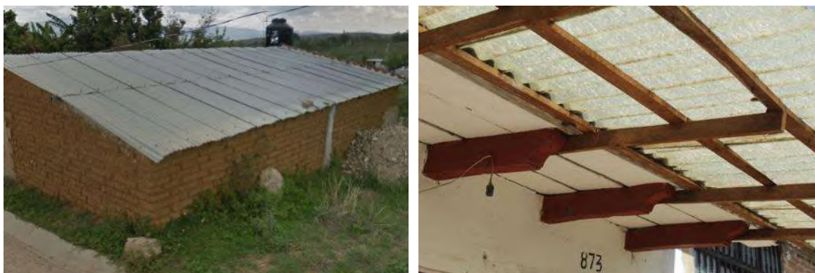
Figura 3.24. Alteraciones de las cubiertas tradicionales en los casos de estudio: (a) Sustitución por cubierta metálica en vivienda en San Pablo Etla, Oaxaca, México; (b) Extensión del alero mediante cubierta semiplástica en vivienda de Ario de Rosales, Michoacán, México. Fotografías: (I. Velasco-Hernández, K. L. Salvador-Alcalá, 2020; A. Sánchez-Calvillo, 2020).
