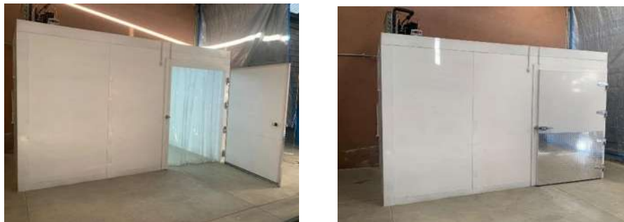
Figura 6.11. Cámara de refrigeración
