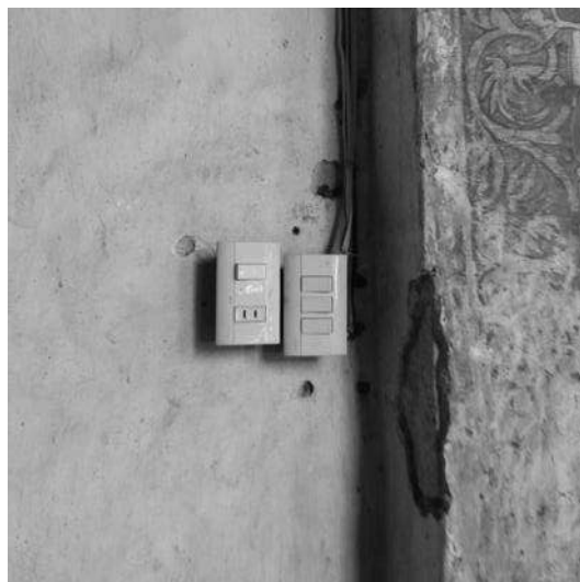
Figura 58: Instalación eléctrica en claustro 122
