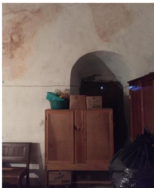
Figura 43: Estado actual de celda 102
