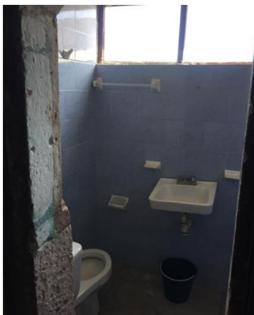
Figura 42: Alteración de baño en celda 101
