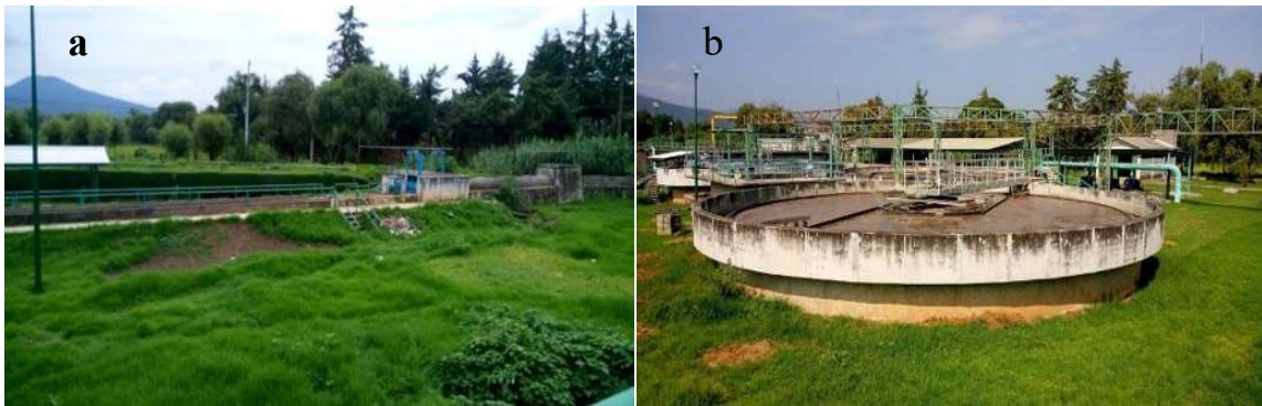
Figura 4-7 a). Influyente del reactor (Canal Parshall) b). Efluente del reactor (Sedimentador secundario) de la PTAR “San Pedrito”, Pátzcuaro, Michoacán.
