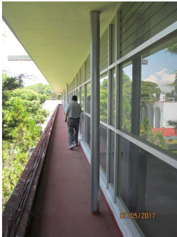
Figura 32. Bajada de agua pluvial de tubo de hierro galvanizado de 4" (fuente: autor).
