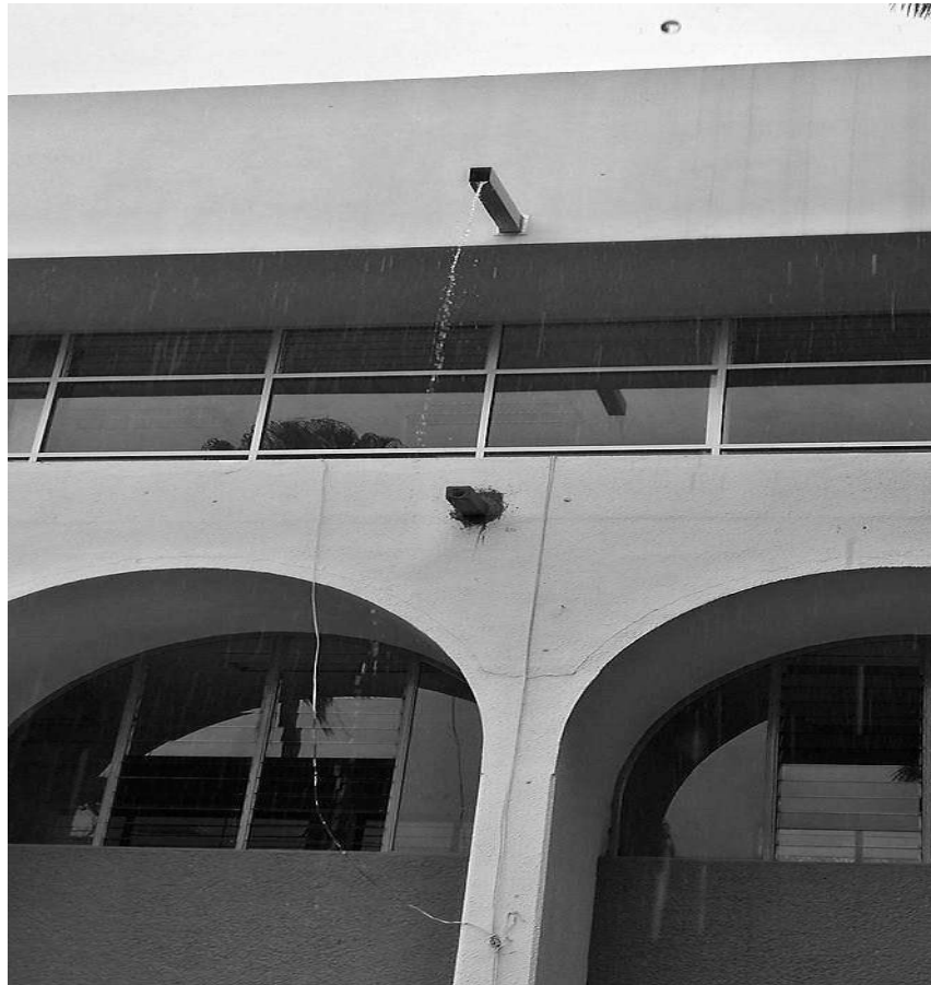
Figura 37. Bajada de agua pluvial del edificio “C” (fuente: autor).
