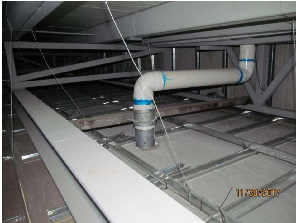
Figura 33. Detalle de conexión de bajada de agua pluvial por tubo de hierro galvanizado (fuente: autor).
