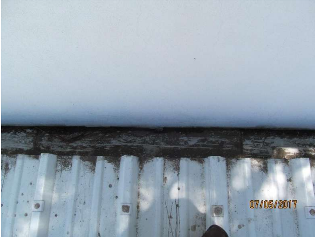
Figura 27. Canaleta sin malla de protección (fuente: autor).
