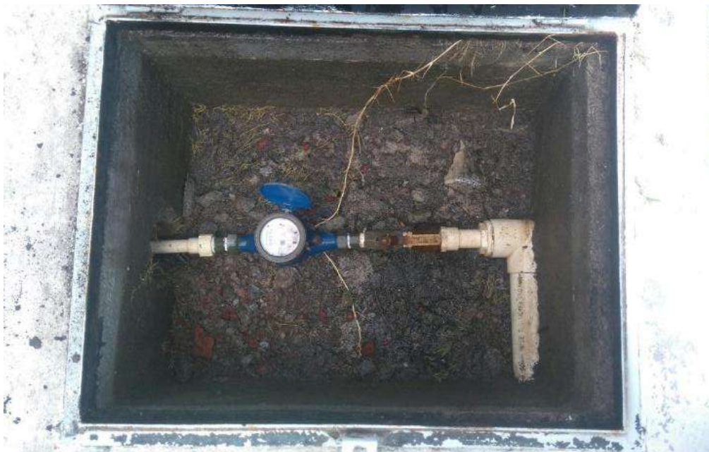
Figura 36. Medidor de agua de la cisterna del edificio “C” (fuente: autor).
