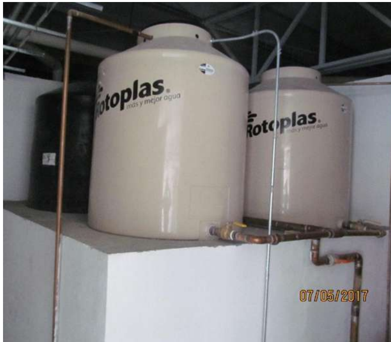
Figura 34. Tinacos de 1100 litros de capacidad (fuente: autor).
