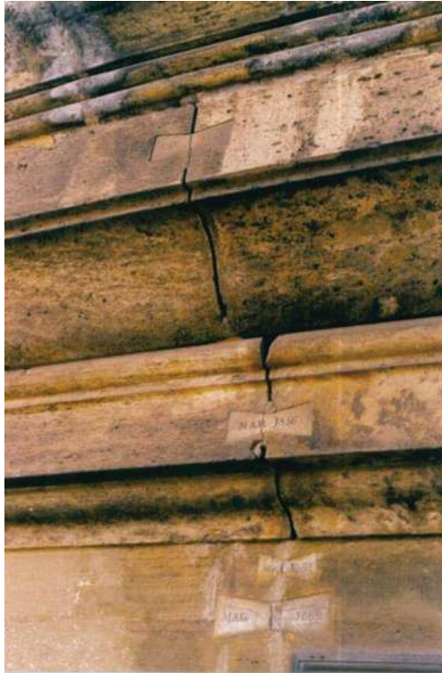
43.-Testigos de la grieta del cimborrio en la cúpula de San Pedro Roma.
