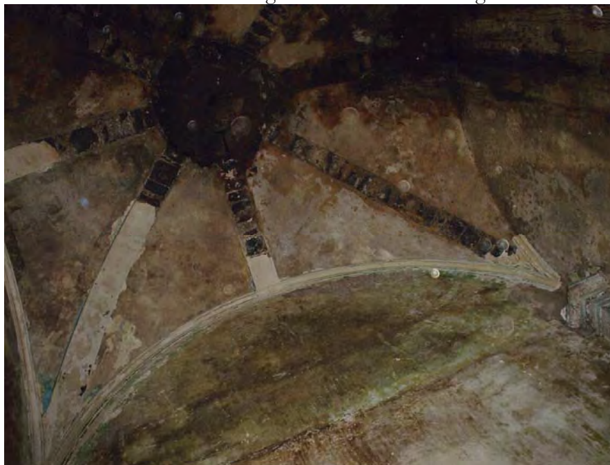
Foto 4 : Bóveda de la iglesia en ruinas de Parangaricutiro
