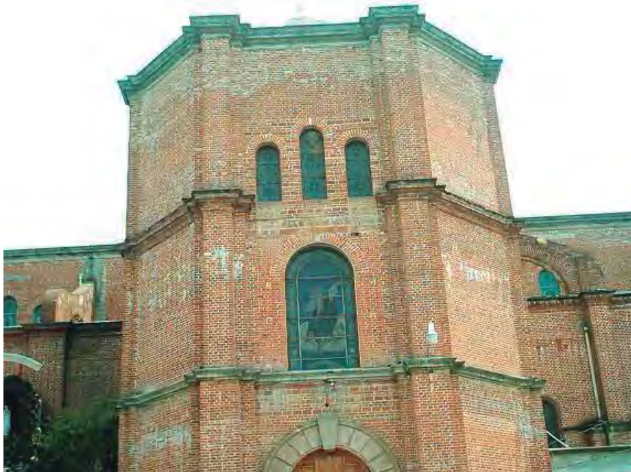
Foto 6: Imagen actual de la torre de la iglesia de San Juan Parangaricutiro
