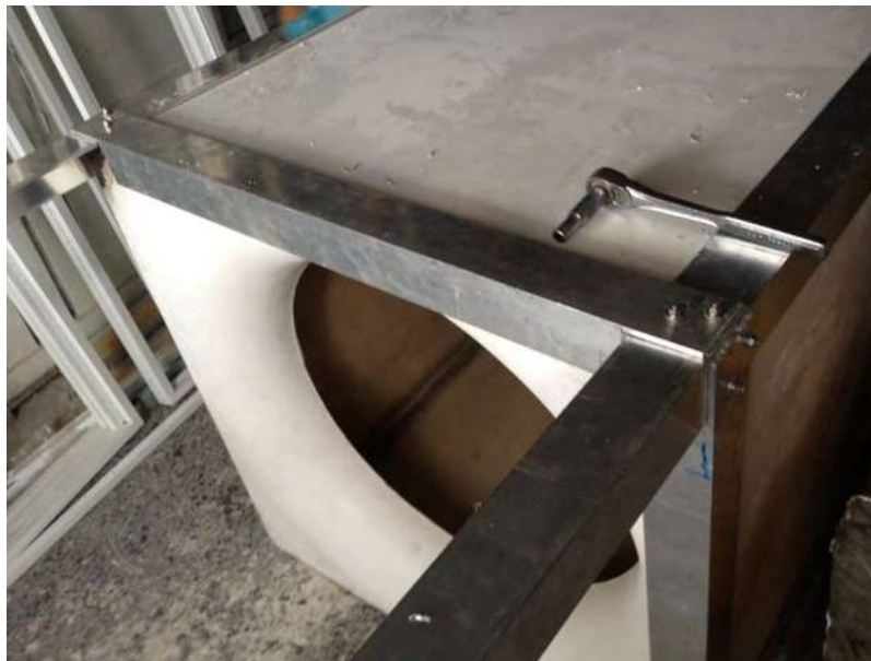
Figura 95. Uniones atornilladas de la estructura de soporte de aluminio.
