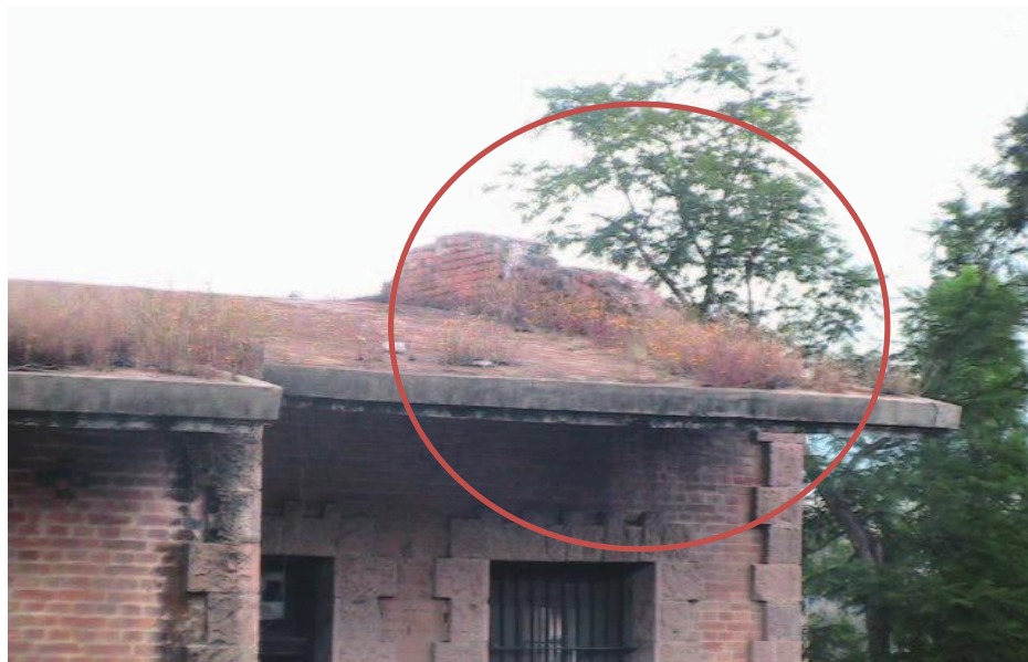
IMAGEN 106. Presencia de micro flora en cubierta. Foto: AEZL.
