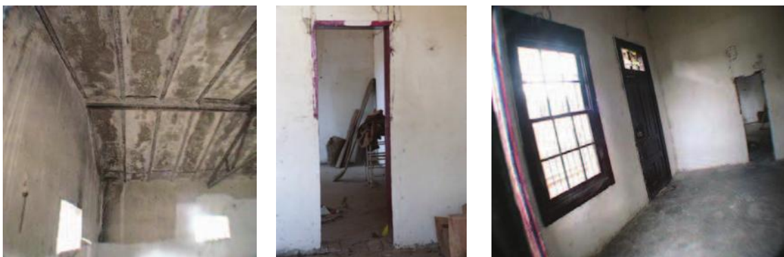
Imagen 043, 044 y 045. Locales 1, 2 y 6 donde se observa el abandono que tiene el edificio. Fotos: AEZL.
