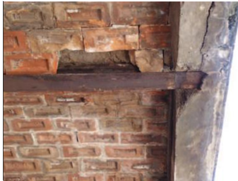
IMAGEN 114. Se puede observar el desprendimiento y falta de ladrillo en el lecho bajo de la cubierta. Foto: AEZL
