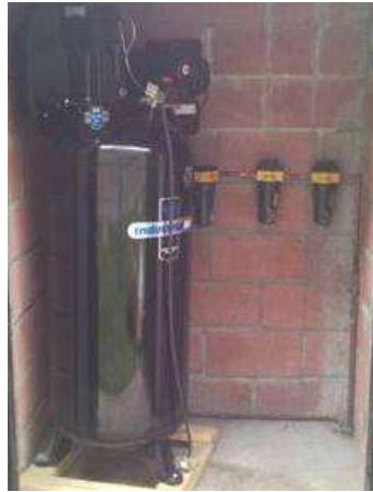
Figura 3.3. Compresor de aire equipado con filtros de aire
