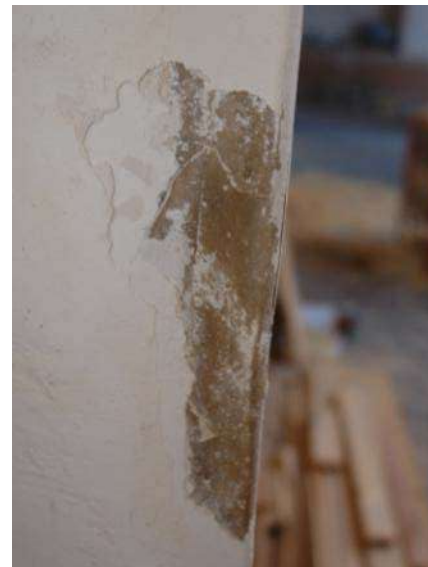
Fig. 32. Desprendimiento de enlucido y aplanado en muro. Foto: la autora.
