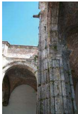
Fig. 96. Desplome de pilastra. Foto: la autora.
