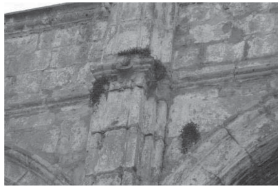
Fig. 30. Desprendimiento de una sección de cornisa por el crecimiento de flora superior. Foto: la autora.
