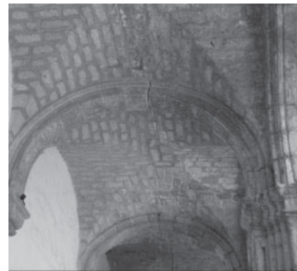
Fig. 97. Vista de los deterioros den arcos torales. Foto: la autora.
