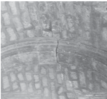
Fig. 95. Falta de junta en dovela. Foto: la autora.
