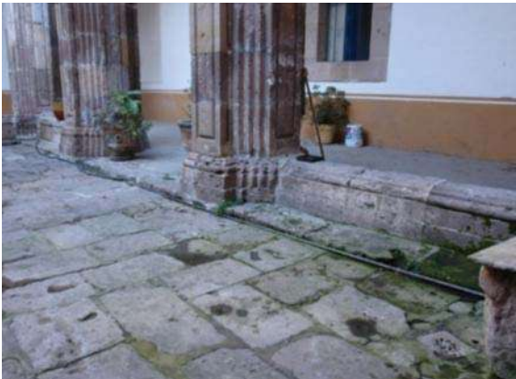
Fig. 37. Imagen en donde es posible apreciar la conjunción de varios agentes causantes de deterioro como por agentes biológicos. Alteración por acciones humanas. Foto: la autora.
