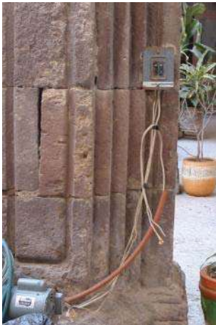
Fig. 92. Instalación eléctrica para la bomba de la cisterna. Foto: autora.
