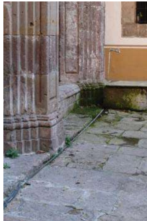
Fig. 93. Tubería visible, causa de líquen. Foto: autora.
