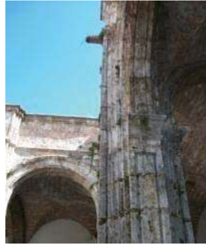
Fig. 31. Desplome de pilastra en la crujía norte. Foto: la autora.
