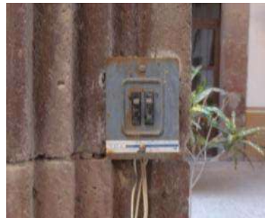
Fig. 78. Interruptor para la bomba de la cisterna. Foto: la autora.
