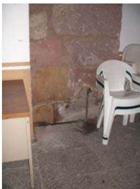
Fig.73. Llave de nariz y tubería expuesta. Foto: la autora.
