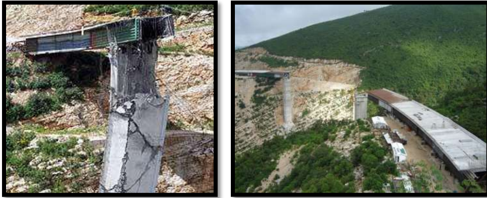
Figura 2.1.e Derrumbe del Puente San Cristóbal.
