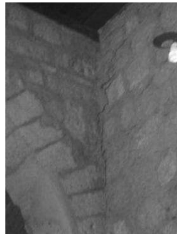
Fig. 21 Acercamiento a la grieta del arco, fuente: Enrique Ruiz Becerril.
