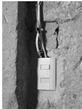
Fig. 29 Cableado expuesto en toda la capilla, fuente; Enrique Ruiz Becerril.
