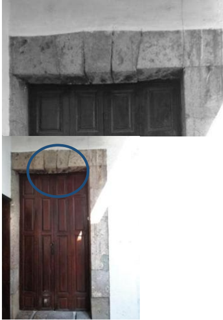
Fig. 43 Deslizamiento de la clave en la puerta de la sacristía, fuente: Enrique Ruiz Becerril.
