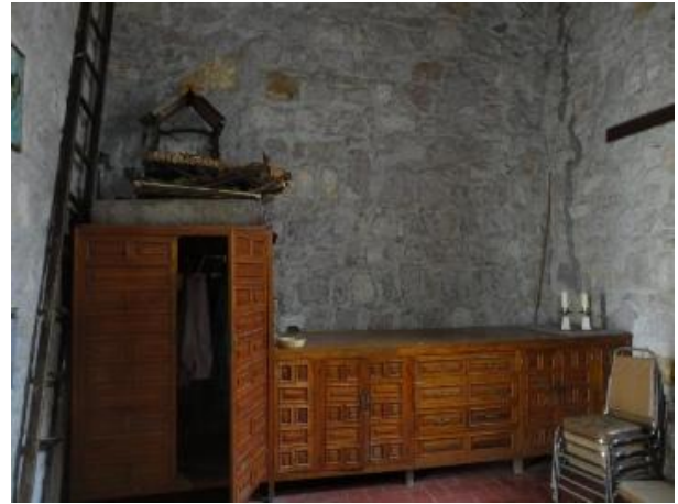
Fig. 44 Grietas en el muro interior de la sacristía fuente: Sandra Merlos
