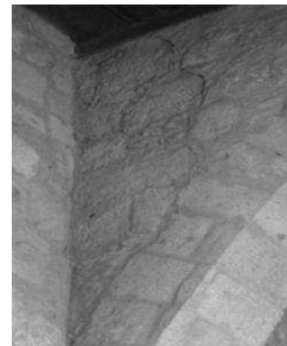
Fig. 31 Grieta en enjuta, fuente: Enrique Ruiz Becerril.
