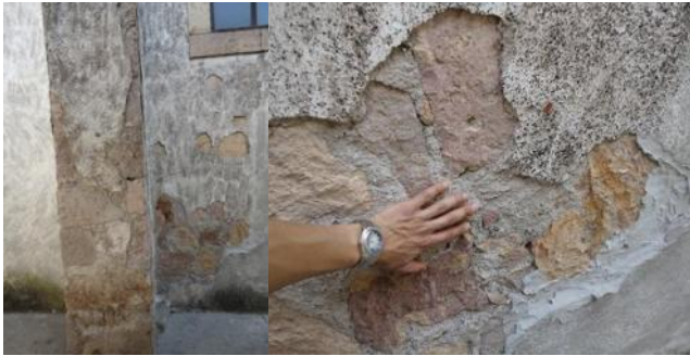
Fig. 8 y Fig. 9 Pérdida de aplanado en muro y contrafuerte debido a la incompatibilidad de materiales, fuente: Enrique Ruiz Becerril.
