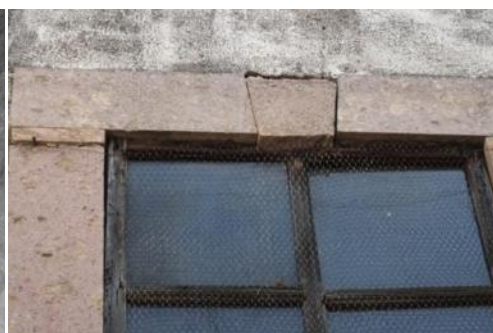
Fig. 42 Deslizamiento de la dovela en el muro oeste, fuente: Enrique Ruiz Becerril.
