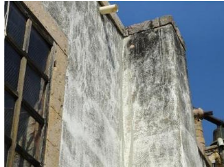
Fig. 10 Presencia de manchas negras en el pretil del muro oriente. pérdida de aplanado en muro y contrafuerte debido a la incompatibilidad de materiales, fuente: Enrique Ruiz Becerril.
