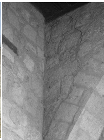
Fig. 41 Detalle de grietas por esfuerzos de tensión fuente: Enrique Ruiz Becerril.
