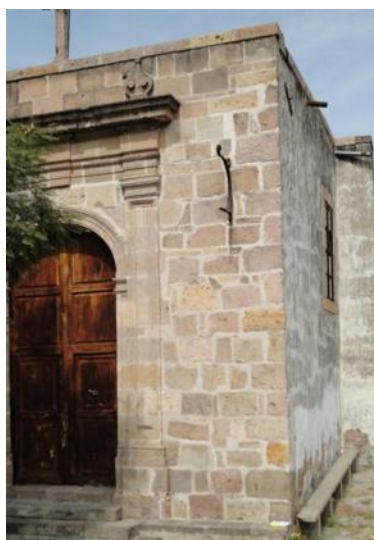
Fig. 40 Detalle donde se observa el desplome del muro de la fachada fuente: Enrique Ruiz Becerril.
