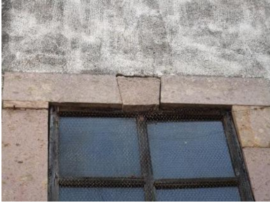
Fig. 18 Deslizamiento de la clave en ventana del muro poniente, fuente: Enrique Ruiz Becerril.
