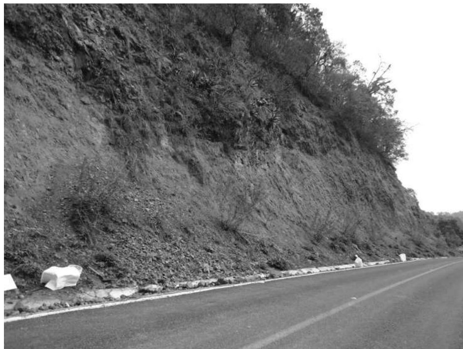
Figura 6.21. Raíces en el talud y material que compone el talud.
