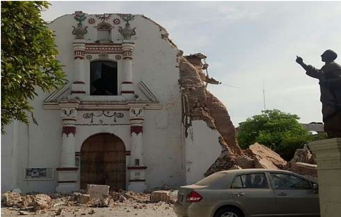
Figura 7.215. Daños en el Templo San Vicente Ferrer en Juchitán, Oaxaca. (1)
