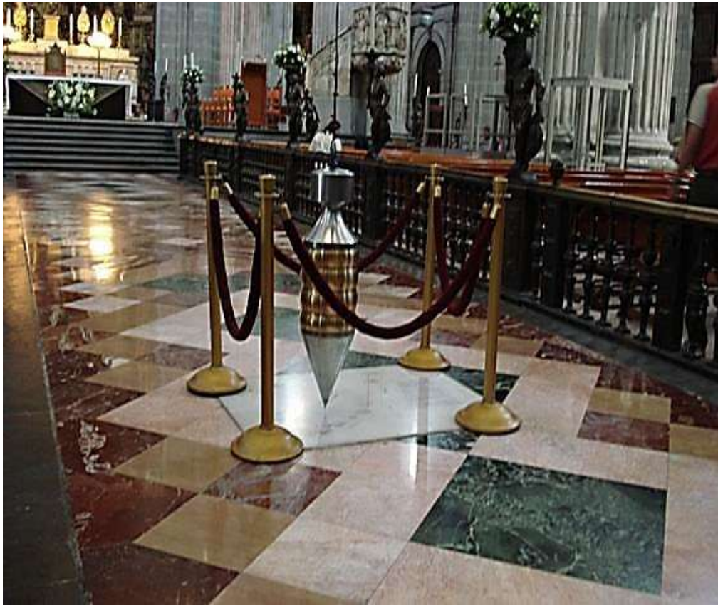
Figura 6.620. Péndulo que mide la inclinación en la catedral metropolitana debido a la presencia de asentamientos diferenciales. Imagen tomada de: https://centrourbano.com .
