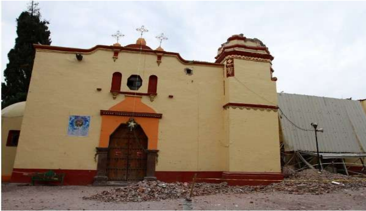
Figura 7.220. Daños en el Templo de San Gregorio Atlapulco, Xochimilco. (3)
