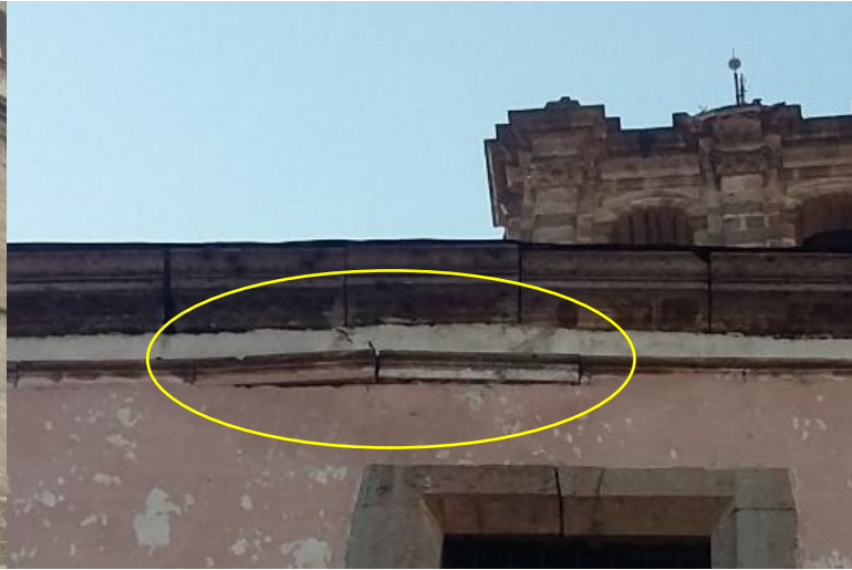
Fig. 149 Grieta causada por empuje lateral ante una acción sísmica 162
