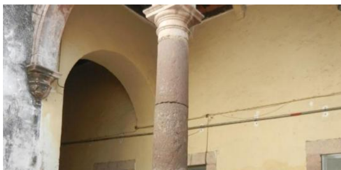
Fig. 91 Tubería de instalación eléctrica en corredores. Se observa el cable aparente y el cableado en tubo. 115
