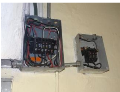
Fig. 94 Centro de carga 118
