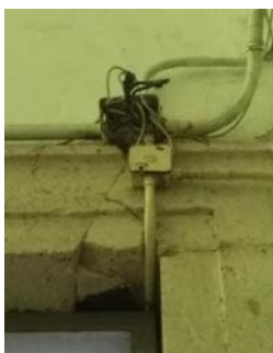
Fig. 93. Platabanda afectada por perforación 117
