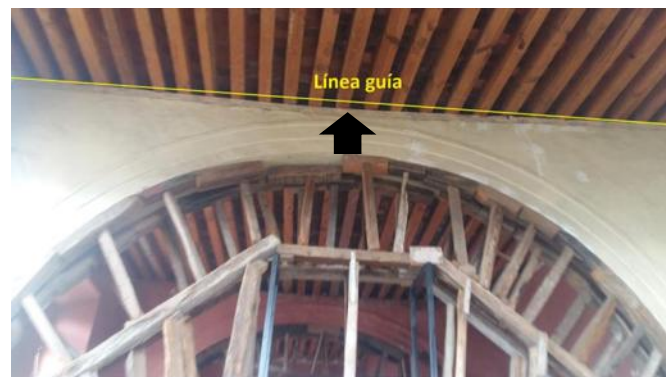
Fig. 151 Deformación actual del arco en la clave 164
