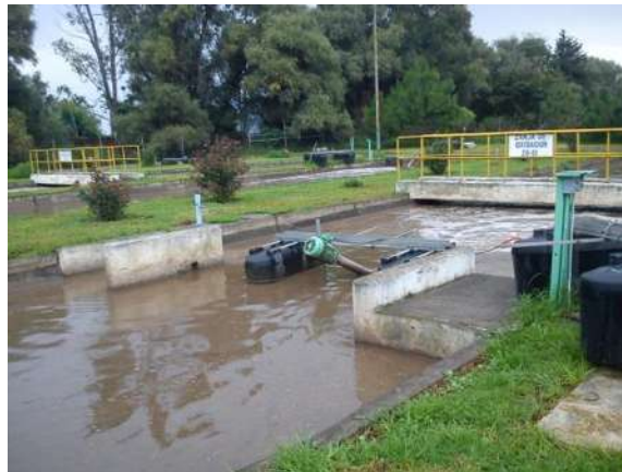
Fig. 3.4 Reactor biológico de la PTAR “las Garzas”, en Pátzcuaro, Mich.
