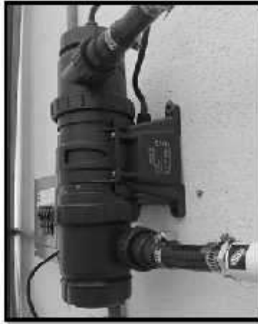
Figura 21. Lámpara UV, medida preventiva de control de calidad del agua de abastecimiento.
