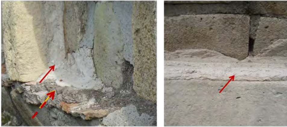
Figura 75. A la izquierda aplanado y mortero de nivelación de una etapa anterior. A la derecha aplanado en la última etapa constructiva del Basamento Este de Plazuelas. La flecha punteada indica el mortero de nivelación y las continuas el aplanado. Fotos: A. Cuéllar
