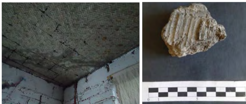
Figura 72. A la derecha una casa contemporánea ubicada en Plazuelas con el uso de petate en el techo. A la derecha fragmento de mortero con huellas de algún tejido similar al petate. También procede de Plazuelas. Fotos: A. Cuéllar
