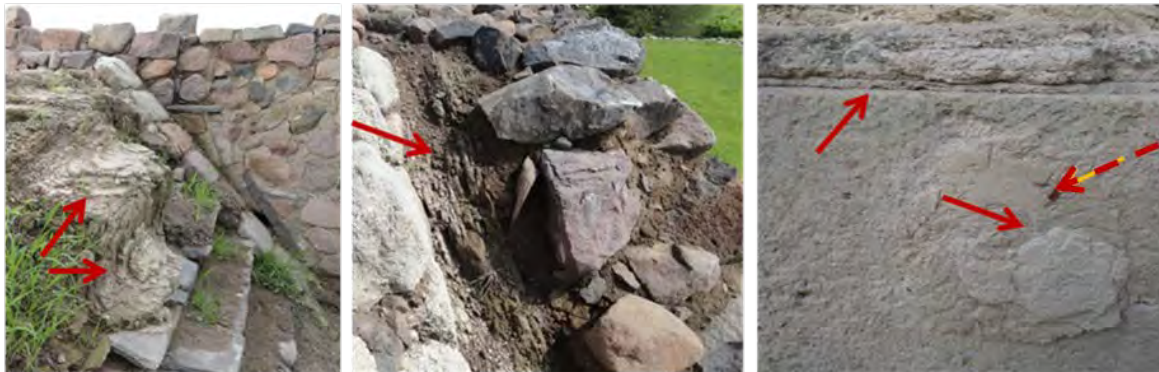
Figura 62. Las flechas indican la superposición de varias capas de aplanado, las cuales son homogéneas indicando que no se trata simplemente de una reparación. La flecha punteada señala la presencia de grava roja comúnmente usada en los aplanados. Procedencia: las imágenes izquierda y central pertenecen a la Estructura 1 de Zaragoza y la imagen derecha a Plazuelas. Fotos: A. Cuéllar
