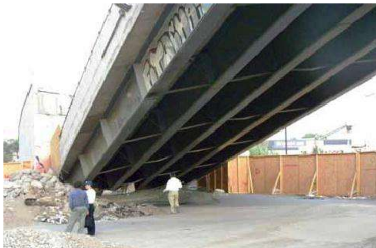
Figura 2.5 Pérdida de asiento del tablero en el estribo del puente Matta-Quilicura debido insuficiente longitud de soporte. Terremoto de Chile de 2010 (Foto: J. Arias)
