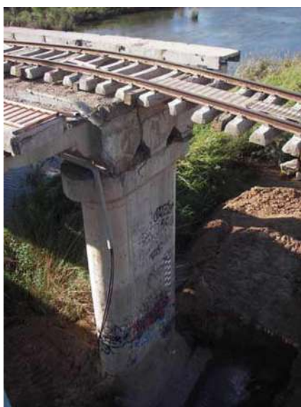
Figura 2.4 Pérdida del asiento de uno de los tableros del puente San Felipito ubicado al sureste de la ciudad Guadalupe Victoria (EERI; Earthquake Engineering Research Institute, 2010).
