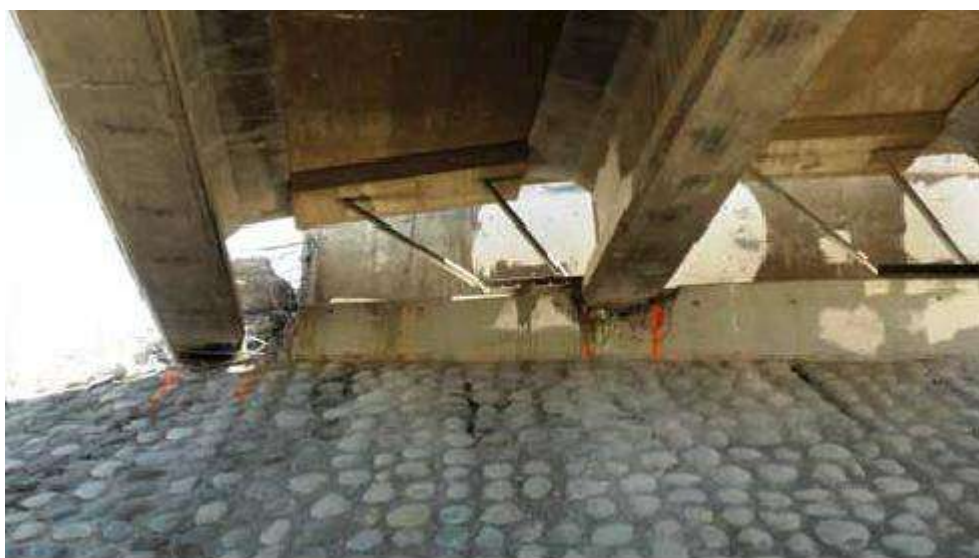
Figura 2.7 Movimiento lateral del tablero del puente Las Mercedes debido a la ausencia de topes laterales (Foto: Ministerio de Obras Públicas).
