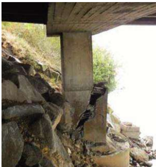
Figura 2.10 Falla por cortante en una pila del puente Juan Pablo II ocurrida durante el terremoto de Chile 2010. (Foto: J. Arias)
