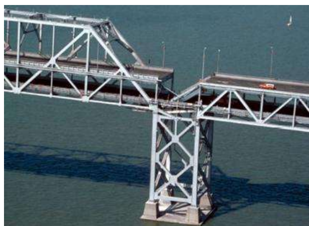
Figura 2.6 Tablero colapsado del puente de la Bahía de Oakland en San Francisco (Foto: C.E. Meyer, USGS).
