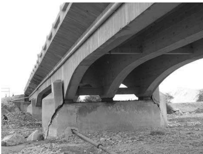
Figura 2.11 Falla por cortante y flexión en algunas pilas del puente Huamani ocasionadas por licuefacción en la zona (EERI; Earthquake Engineering Research Institute, 2007).
