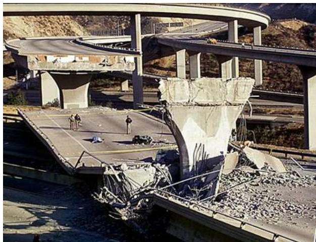
Figura 2.3 Colapso del puente de la ruta 14/15 debido al terremoto de Northridge California en 1994 (USGS 1995).
