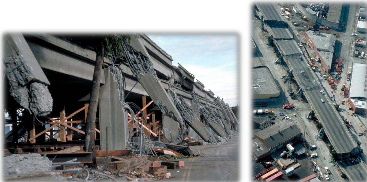
Figura 2.1 Falla en las columnas y colapso del piso superior del viaducto de la calle de Cypress durante el terremoto de Loma Prieta M=6.9 de 1989 (Fotos: H.G. Wilshire, USGS).
