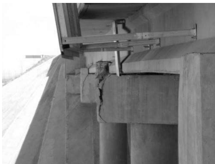
Figura 2.12 Daño en los cabezales del puente de la Autopista 2 en Baja California (Foto: Majid Sarraf 2010)
