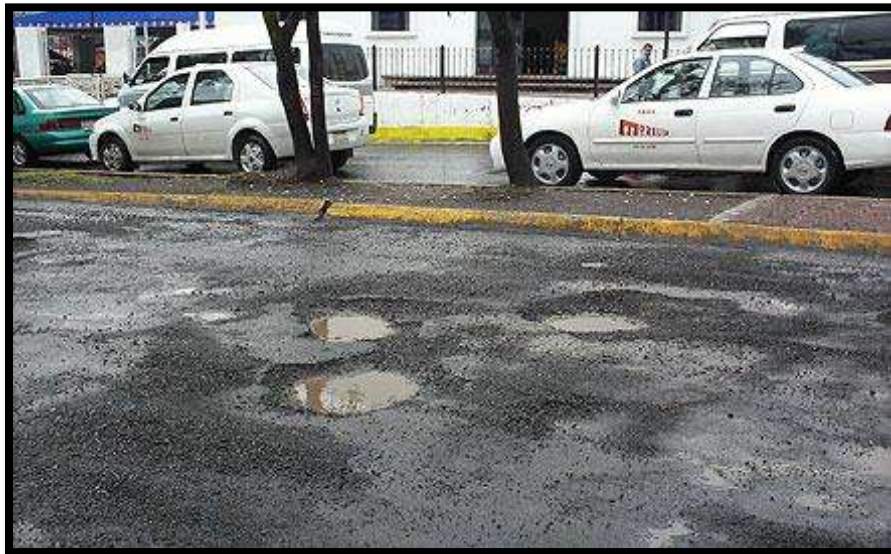
Fig. IV.3 Deterioro de las calles de Morelia durante época de lluvias, como consecuencia de la presencia de arcilla en el agregado pétreo.
