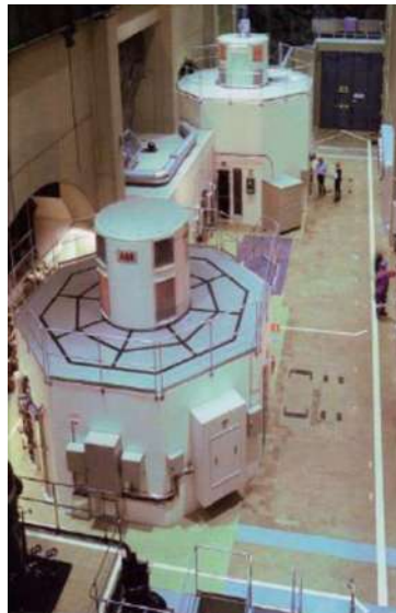
Figura 3. Instalaciones Centro Hidroeléctrico Porjus en Suecia [8].
