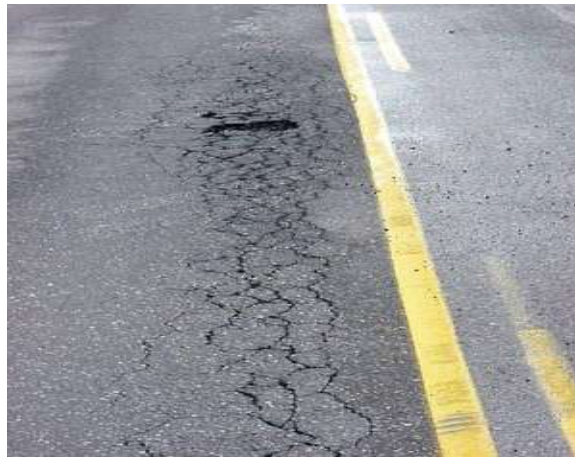
Fig. 4 Pavimento asfáltico maltratado
