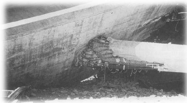
Figura 1.8 Falla en la parte superior de la columna debido al mal confinamiento, sismo de San Fernando, 1971 (Tomada de Priestley et al., 1996)
