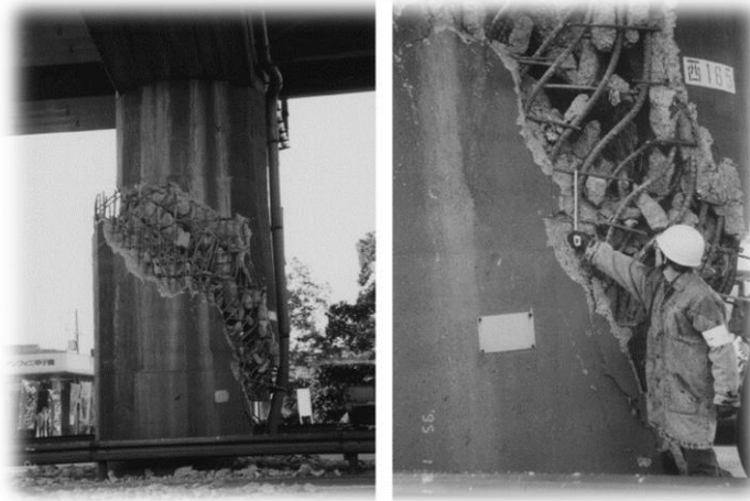
Figura 1.10 Falla de la columna por cortante (Tomada de http://www.sciencedirect.com/science/article/pii/S0141029697002034 )
