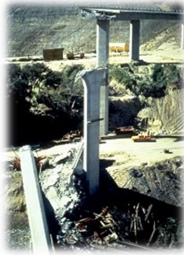
Figura 1.3 Colapso de una Viga, Sismo San Fernando, 1971
