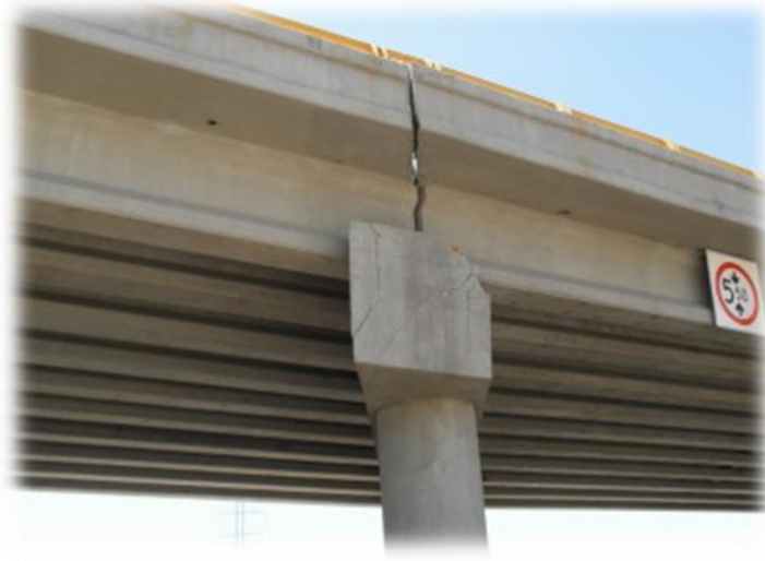
Figura 1.12 Falla en el cabezal, sismo en Baja California, 2010. (tomada de http://www.eqclearinghouse.org/20100404-baja/general-information/bridge-damage-observations-from-majid-saaraf )
