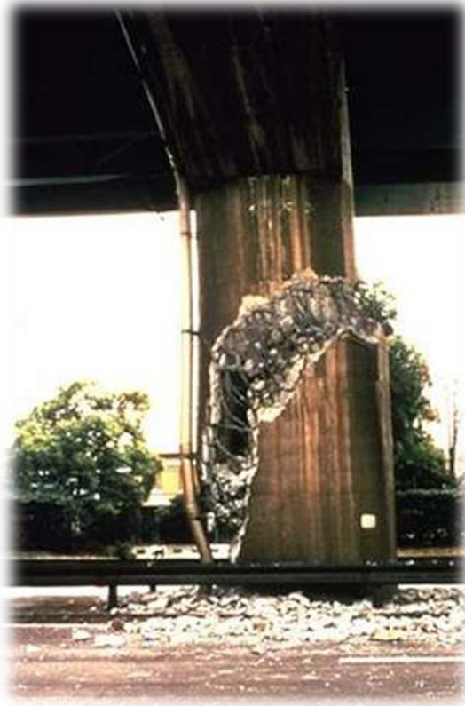
Figura 1.11 Falla de columna por cortante, sismo de Kobe, 1995 (tomada de http://www.grupoksv.com/columnas-cortas-en-el-diseno-estructural )
