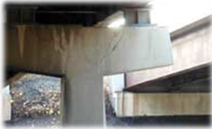
Figura 1.13 Falla de cortante en el cabezal. (Tomada de http://www.cts.umn.edu/Publications/researchenews/2006/01/ )
