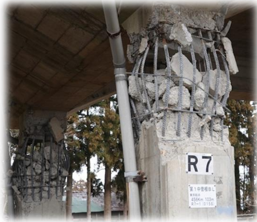
Figura 1.7 Refuerzo de la columna inadecuado (tomada de http://transport.cat/viewtopic.php?f=4&t=9826&start=240 )
