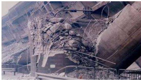
Figura 2.2 Colapso del puente
