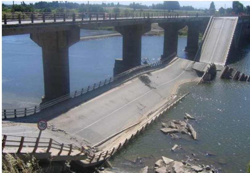
Figura 2.1 Colapso de un puente debido a la pérdida de asiento
