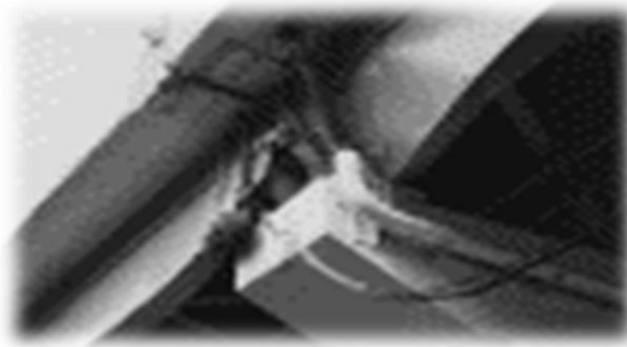
Figura 1.14 Falla en la viga de acero, sismo Kobe, 1995 (tomada de http://www.sciencedirect.com/science/article/pii/S0141029697002034#FIG1 )
