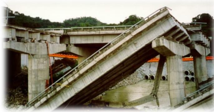
Figura 1.1 Colapso del puente Shi Wei en Taichung, debido a la pérdida de asiento. Sismo Chi Chi, 1999.
