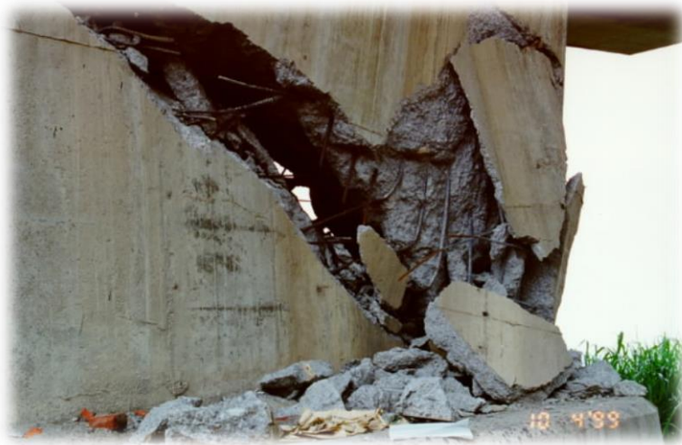
Figura 1.2 Grieta de cortante en la pila de concreto del puente Wu Shu bridge in Taichung. Sismo Chi Chi, 1999
