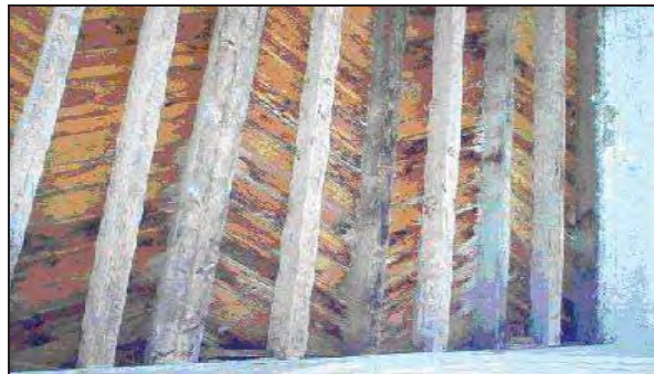
Figura 19. Deterioro presentado en el entrepiso del portal de sacramentos.
