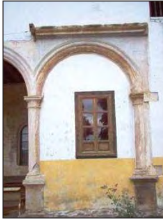
Figura 10.- Vano tapiado en el portal de sacramentos
