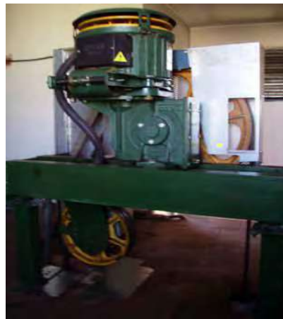
Fig. 1.3 Conjunto motor de los elevadores electromecánicos [24]
